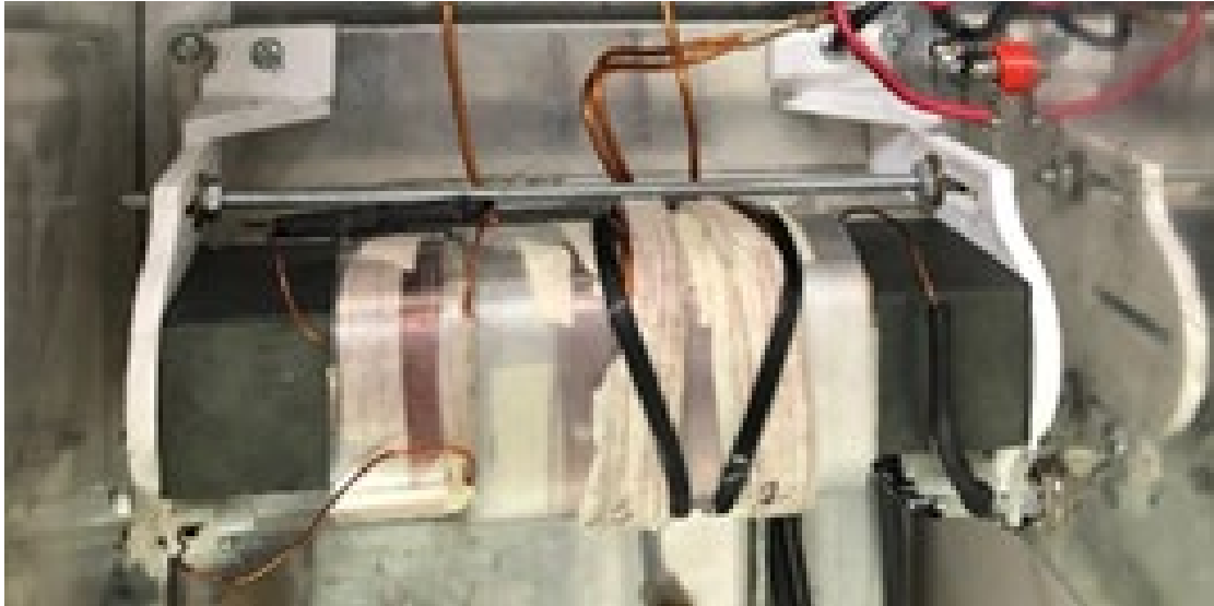
Figura 3.9 Transformador T1 instalado en su caja metálica (sin tapa).
