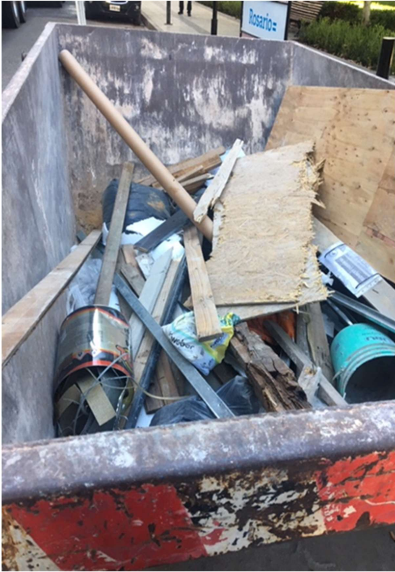
Figura 18. Fotografía tomada en la Obra 2. Contenedor metálico 3 con restos de obra de diferentes tipos, acopiados juntos dentro del volquete. Fuente: Elaboración propia.
