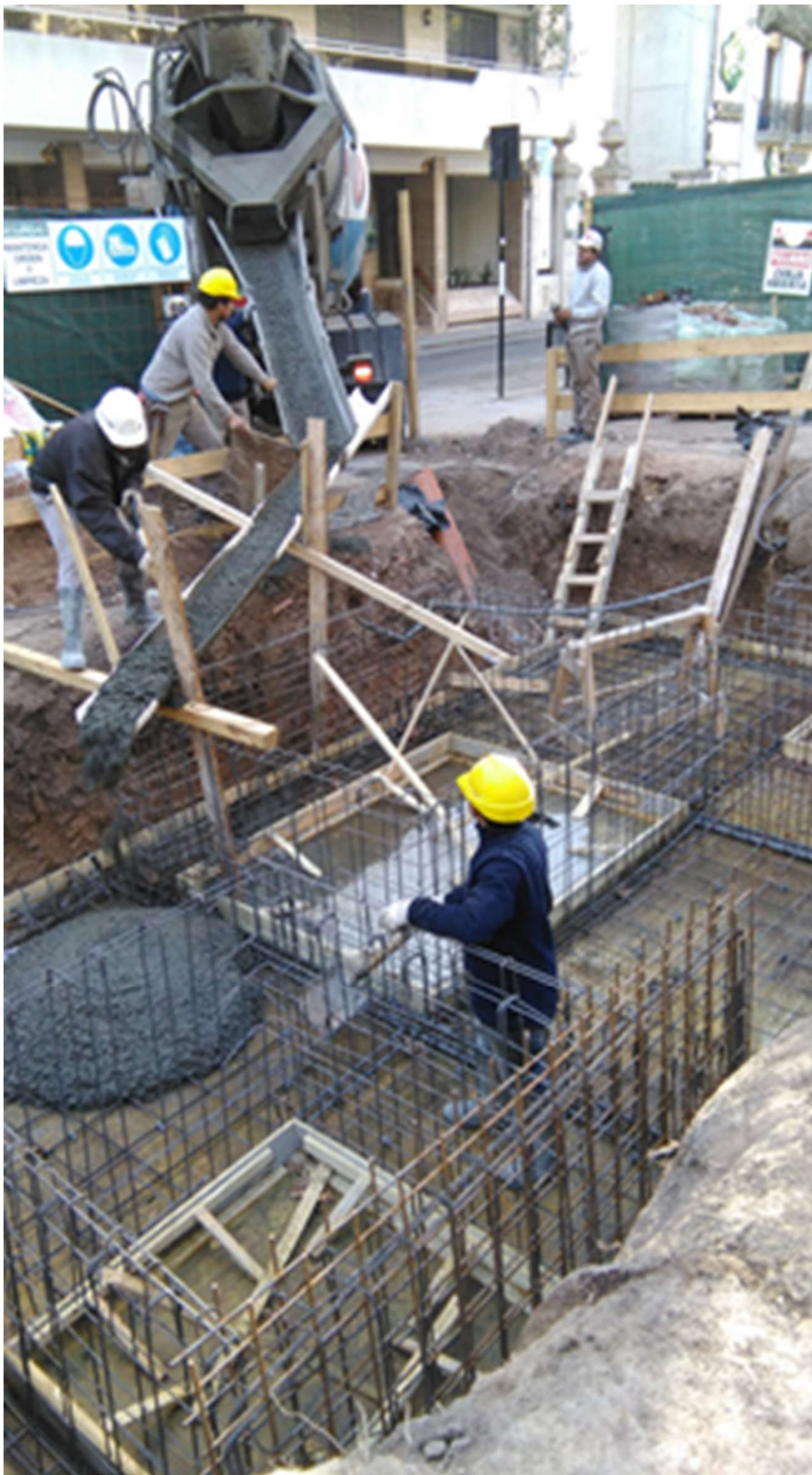
Figura 16. Fotografía tomada en la Obra 1. Restos de hormigón que crearán desniveles y afectarán la circulación de trabajadores. Fuente: Elaboración propia.
