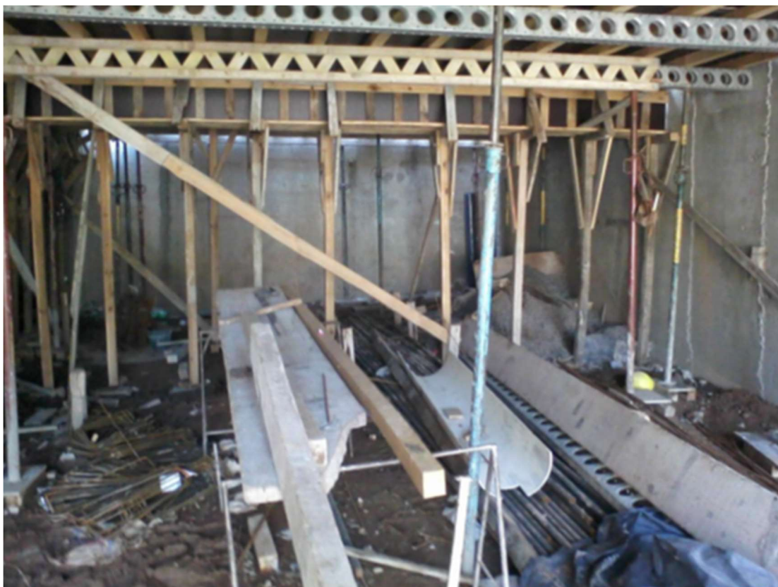
Figura 27. Fotografía tomada en la Obra 5. Plano de trabajo completamente desordenado y ocupado por restos de obra que, finalmente, serán descartados. Fuente: Elaboración propia.
