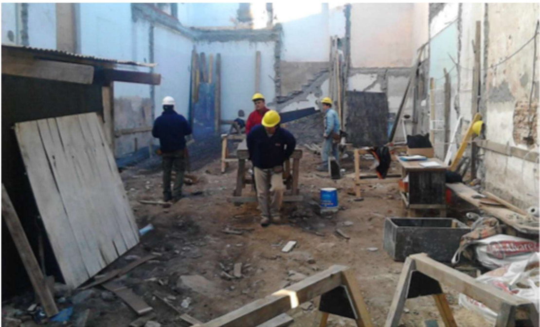
Figura 22. Fotografía tomada en la Obra 4. Desorden de restos de obra que entorpece la circulación, creando riesgo de caídas al mismo nivel. Fuente: Elaboración propia.
