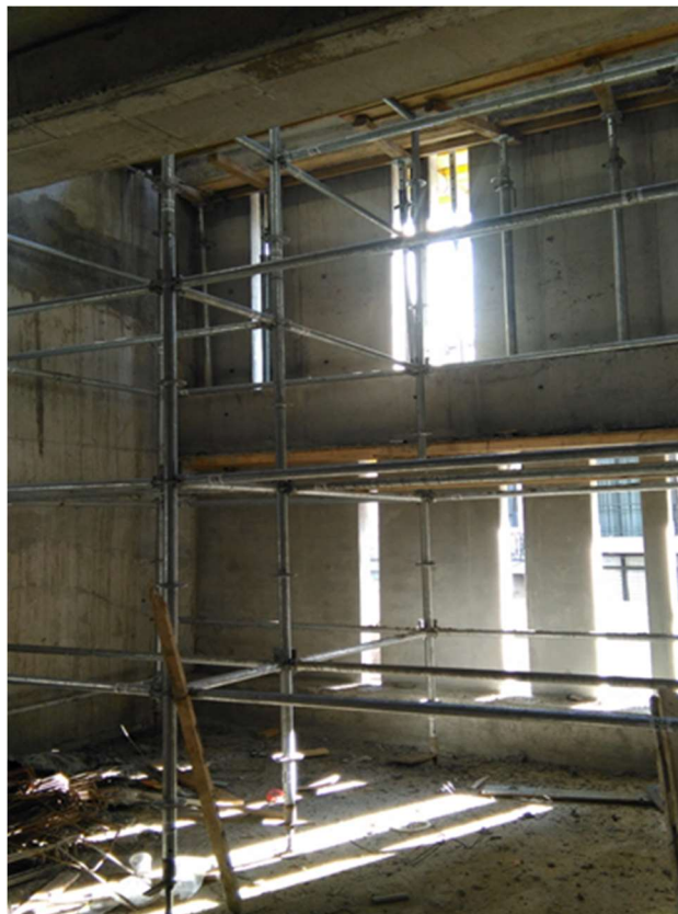
Figura 17. Fotografía tomada en la Obra 1. Los restos de diferentes materiales desordenados en el suelo, generan riesgo de caídas al mismo nivel para los trabajadores. Asimismo, considerando que muchos de ellos son alambres y recortes de metales, también existe riesgo de heridas corto-punzantes. Fuente: Elaboración propia.
