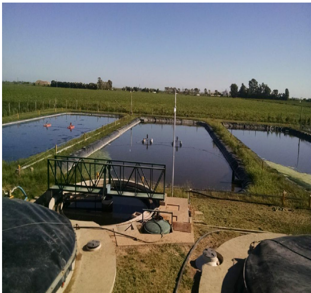
Fotografía 6: Vista de 3 lagunas aeróbicas.
