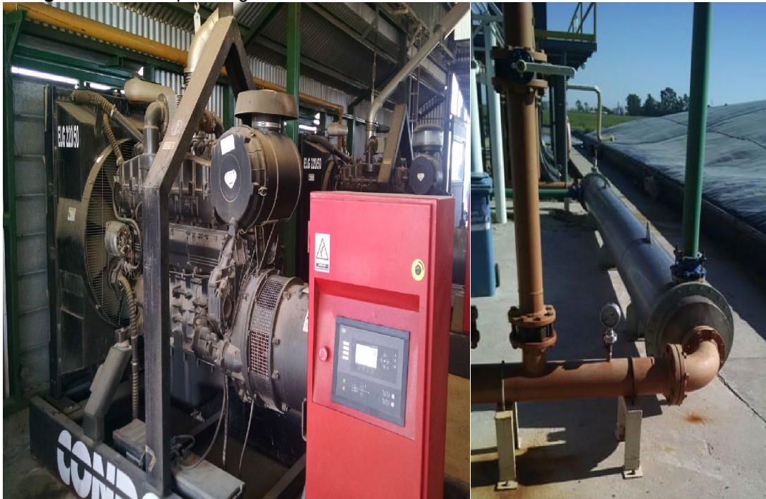
Fotografía 13: Generador. Funciona con biogás.
