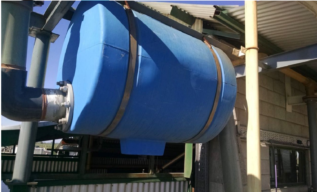
Fotografía 12: Trampa de agua.
