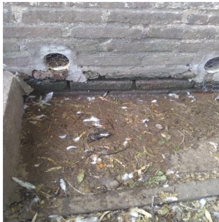
Imagen N°74: humedad acumulada en el acceso a parque de CC densidad muy alta
