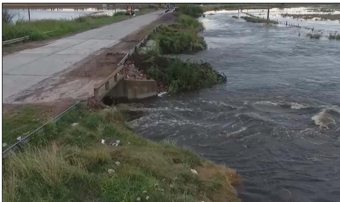
Figura N°E7: Escurrimiento del agua en secciones de control para el evento diciembre 2016-enero 2017.
