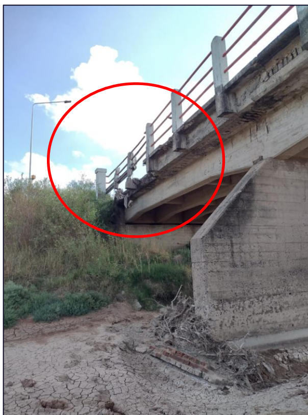
Imagen N° 2.3.3. Impacto sobre cordón de puente. Destrucción de baranda.
