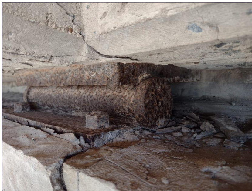
Imagen N° 2.3.10. Estado actual Rodillos metálicos.
