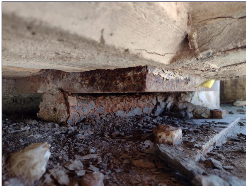
Imagen N° 2.3.9. Estado actual Rodillos metálicos.
