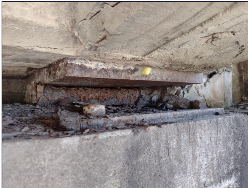
Imagen N° 2.3.8. Estado actual Rodillos metálicos.
