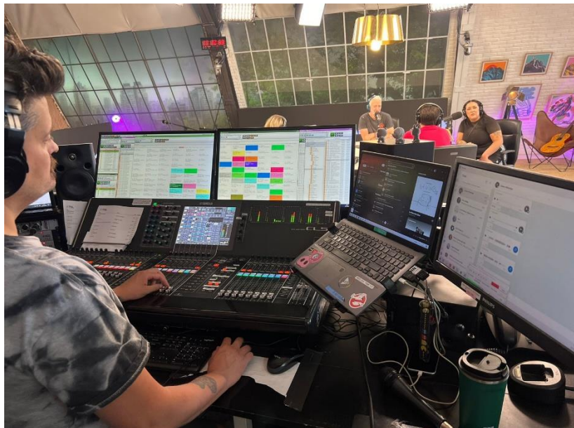
Imagen 14 (obtenida en la observación in situ) - consola del operador, con las pantallas.
