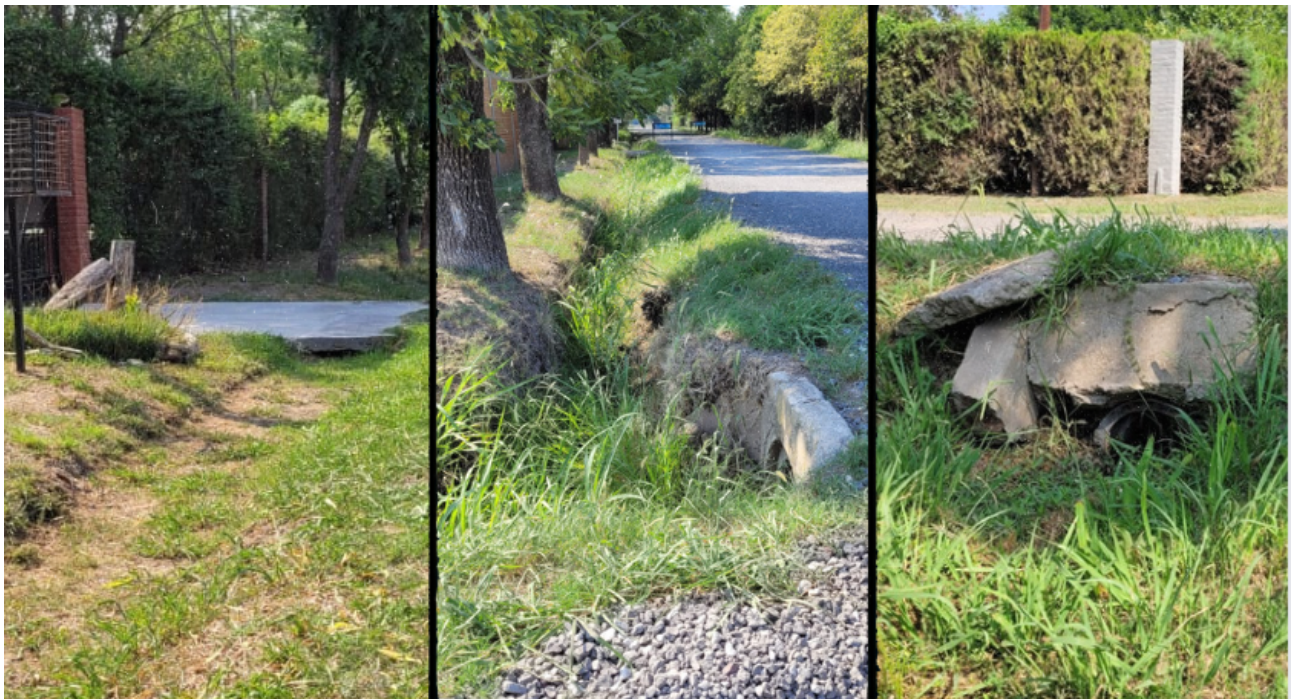
Figura 7 - Estado actual de las cunetas.
