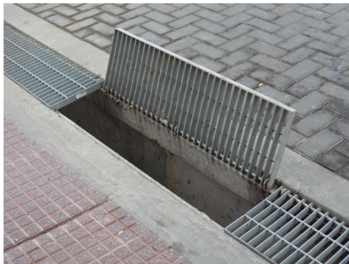
Alcantarilla Rebatible Línea media
