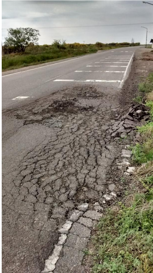
Imagen n° 33: Estado superficial RP2 (Las Avispas – Santa Fe) (Fuente propia).
