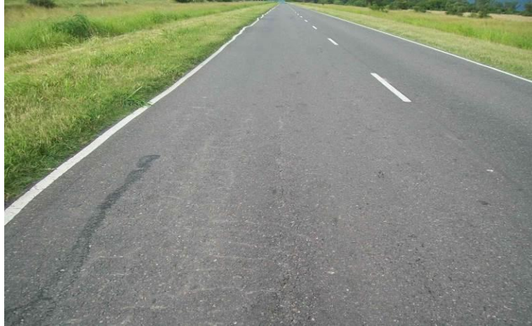
Imagen n° 35: Estado superficial RP2 (Fuente propia).
