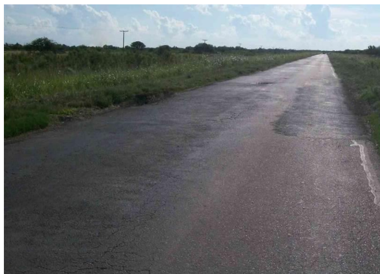
Imagen n° 34: Estado superficial RP2 (Fuente propia).
