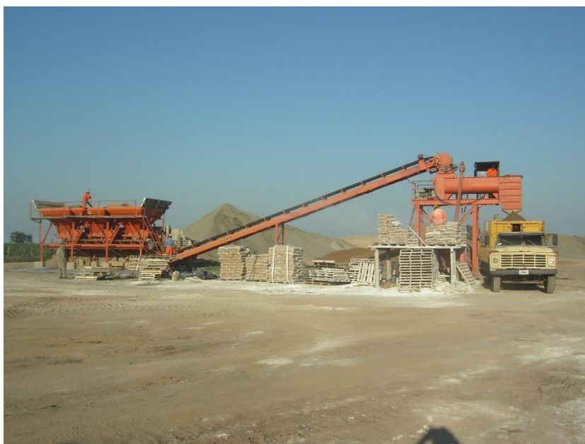
Imagen n° 10: Planta de elaboración fija. (Fuente: Archivo Dirección Obras DPV Santa Fe)
