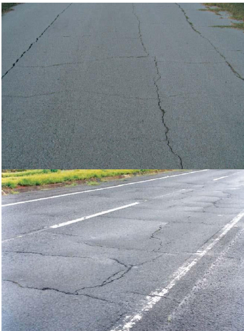
Imagen n° 12: Fisuración en pavimentos. Autopista SP-280, Brasil (arriba) y Ruta SH-47, Texas, EUA (abajo). (Saxena, Tompkins, Khazanovich, & Balbo, 2010) [40]
