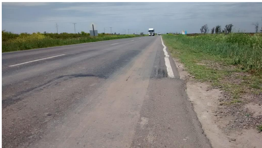
Imagen n° 39: Estado superficial RP2 (Tostado - Santa Fe) (Fuente propia).
