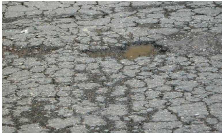
Imagen n° 13: Deterioro por efecto de bombeo (Imagen superior inicios, imagen inferior deterioro avanzado).
