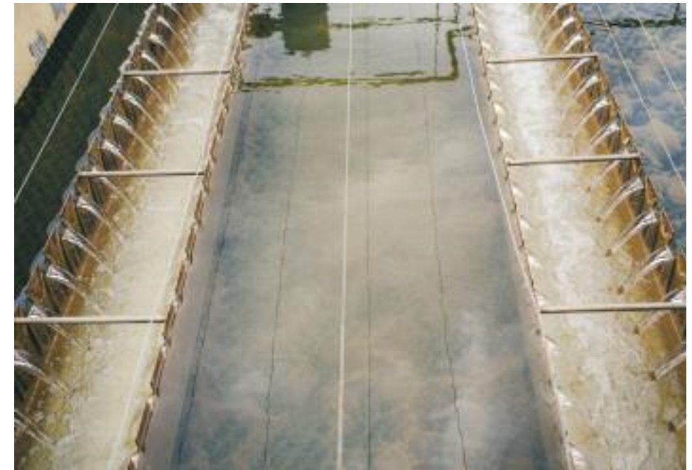
Piletas planta potabilizadora
