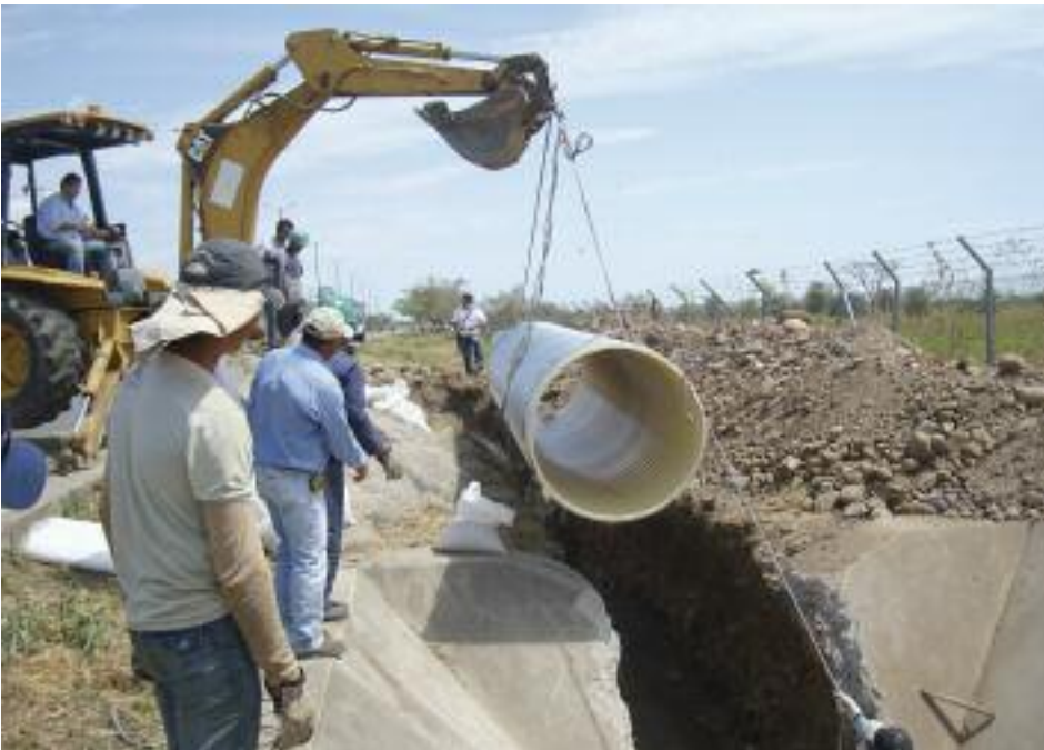
Acueducto Norte 1 - Desvío Arijón
