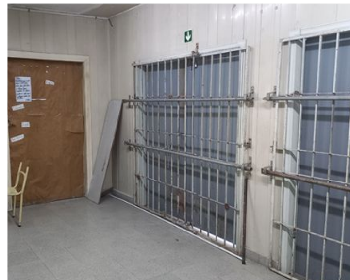
235- Salida de emergencia y ascensor que actualmente no funciona.
