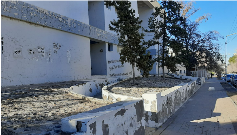
271- Rampa para personas con movilidad reducida.
