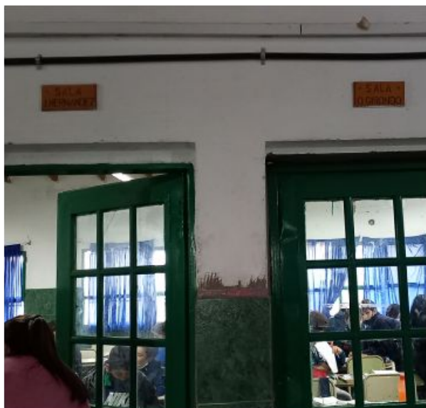
213- Dimensiones inapropiadas para movilidad reducida.
