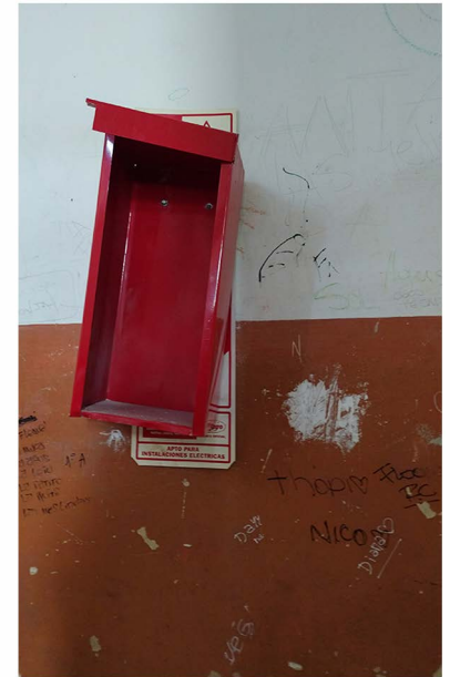
98- Inexistencia de matafuegos.
