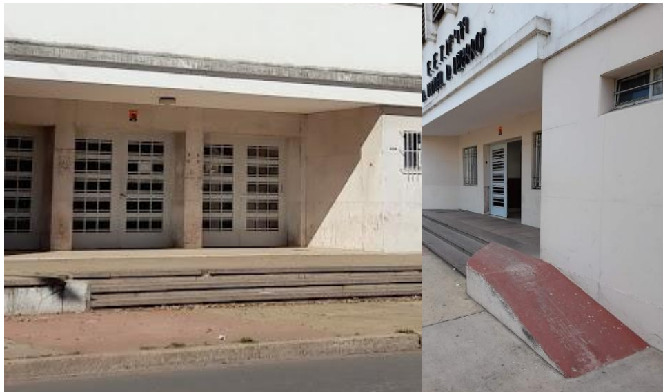
169- Acceso principal y secundario con escalinata y rampa no reglamentaria.
