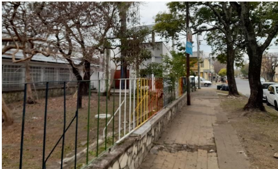
149 -Veredas con alto grado de deterioro. Dificultades en la accesibilidad..
