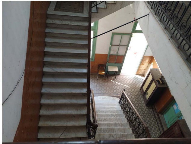
99 y 100- Escalera: única circulación vertical existente para conexión entre plantas.
