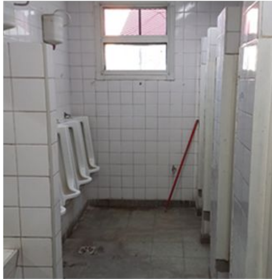
236- Baños por sexo con batería de mingitorios.
