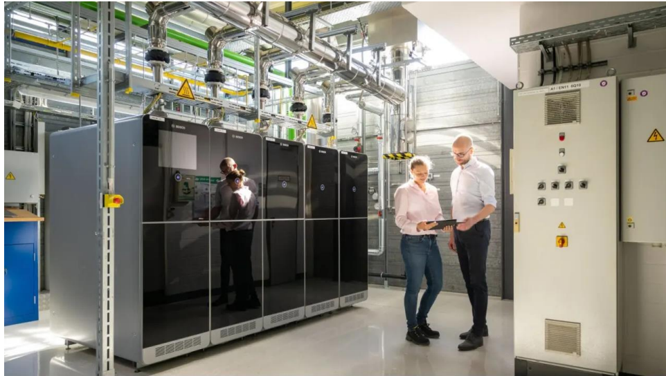
Figura 5-95: Stack y configuración de celdas SOFC instaladas en Wernau.
