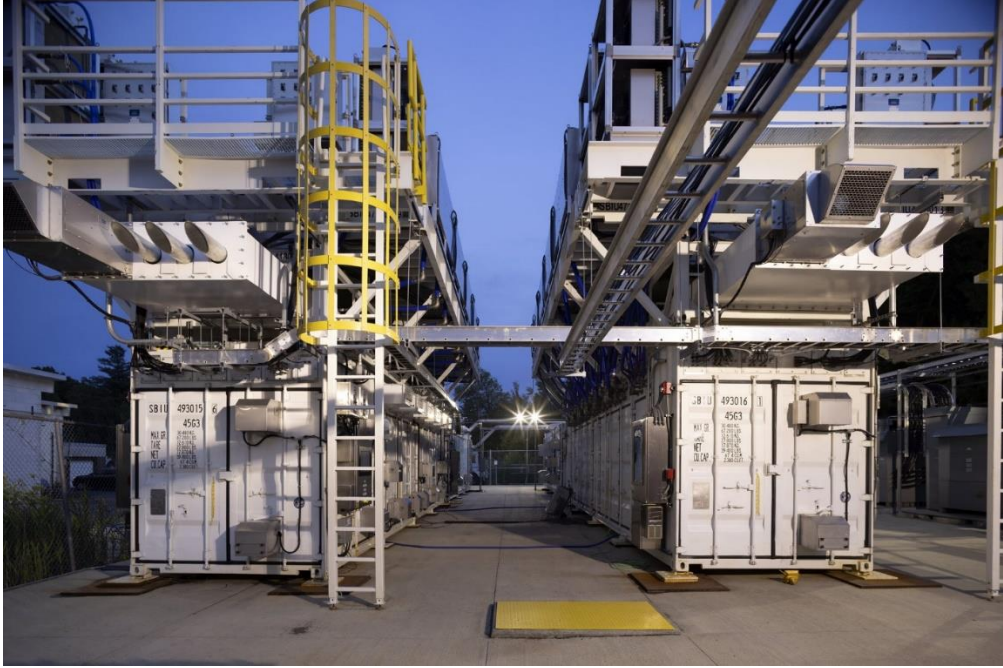
Figura 5-91: Vista lateral sistema de celdas de combustible.
