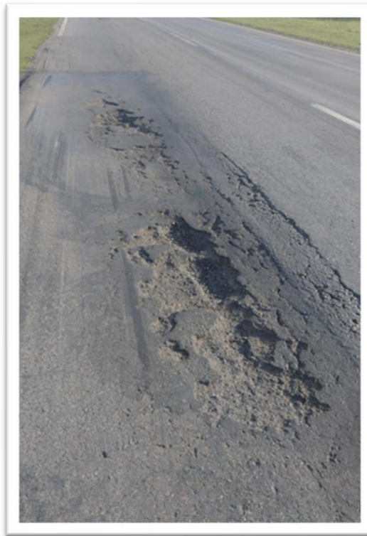
Figura 6. Bache sobre bache con desprendimiento
