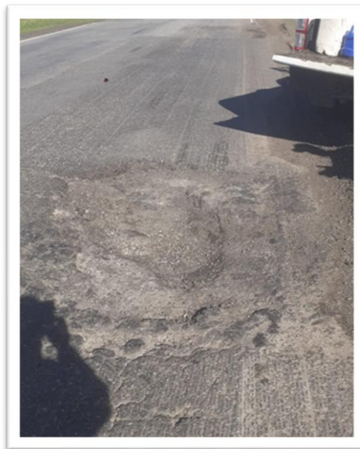
Figura 7. Bache con desprendimiento
