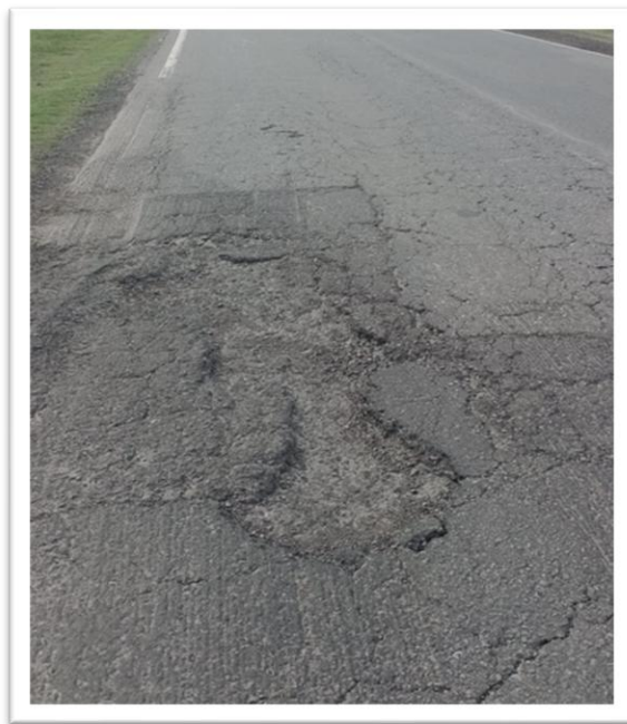
Figura 9. Bache sobre bache con desprendimiento
