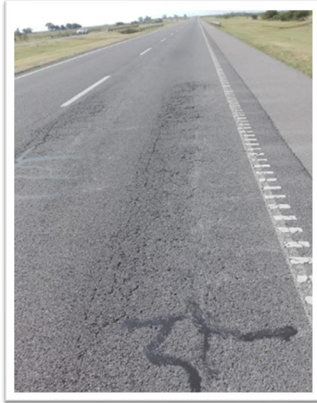
Figura 4. Ahuellamiento y Bache
