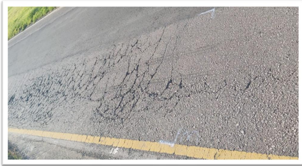
Figura 31. Bache delimitado sobre huella externa izquierda
