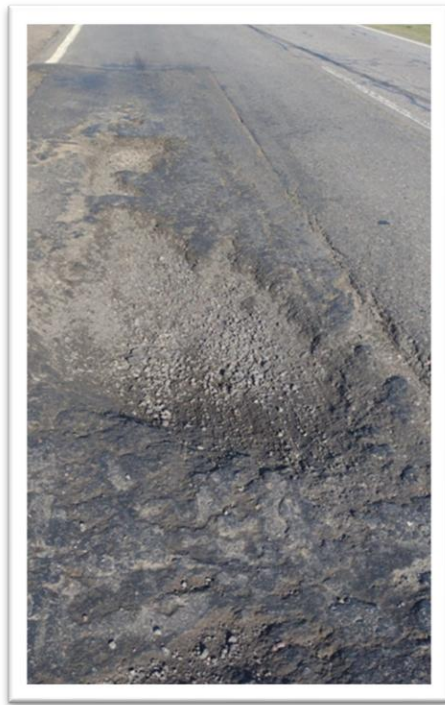
Figura 8. Bache sobre bache con desprendimiento
