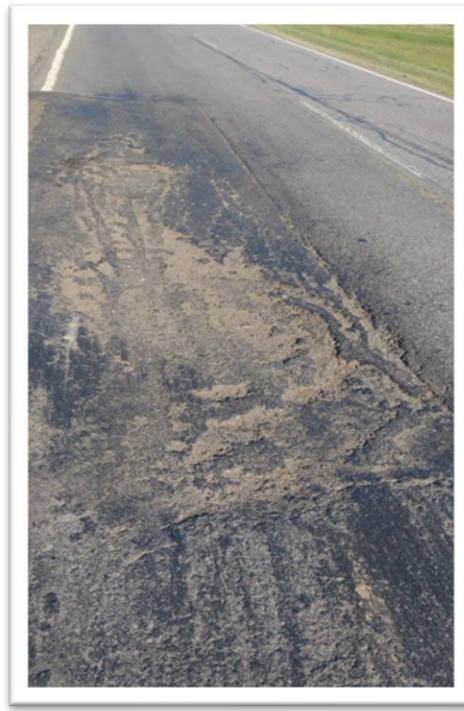
Figura 10. Bache sobre bache con desprendimiento
