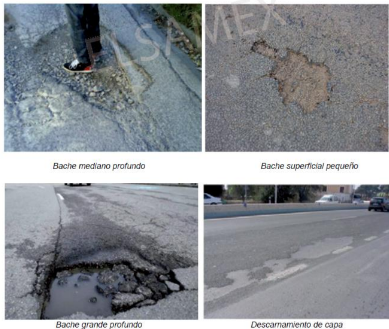
Figura 66. Evolución de un bache (LanammeUCR, Guía para inspectores para bacheo formal con mezcla asfáltica en caliente. Segunda edición., 2021)
