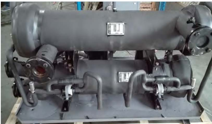
Figura 2. 35 Intercambiador de calor
