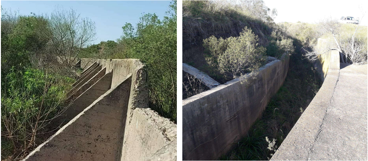
Figura 4.20 - Canal de derivación de la antigua minicentral hidroeléctrica instalada en el arroyo.
