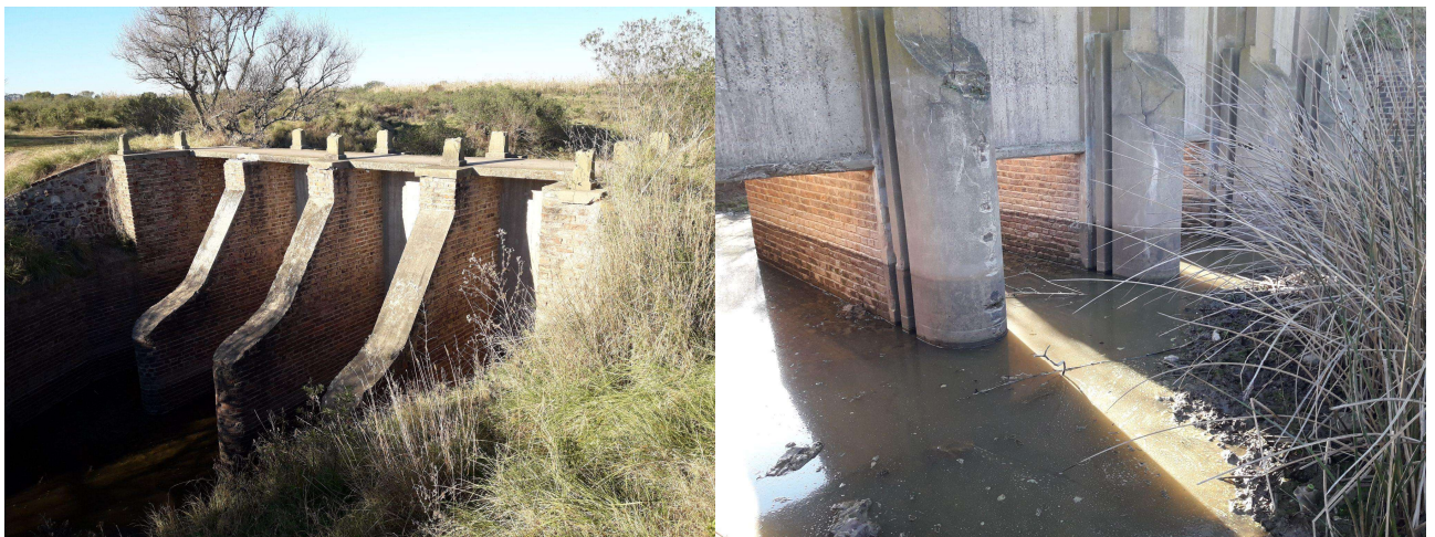
Figura 5.24 – Compuertas de control sobre el inicio del canal de derivación.
