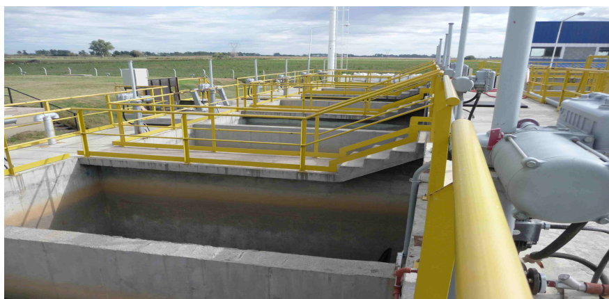
Figura N° 9: Filtros de PPM
