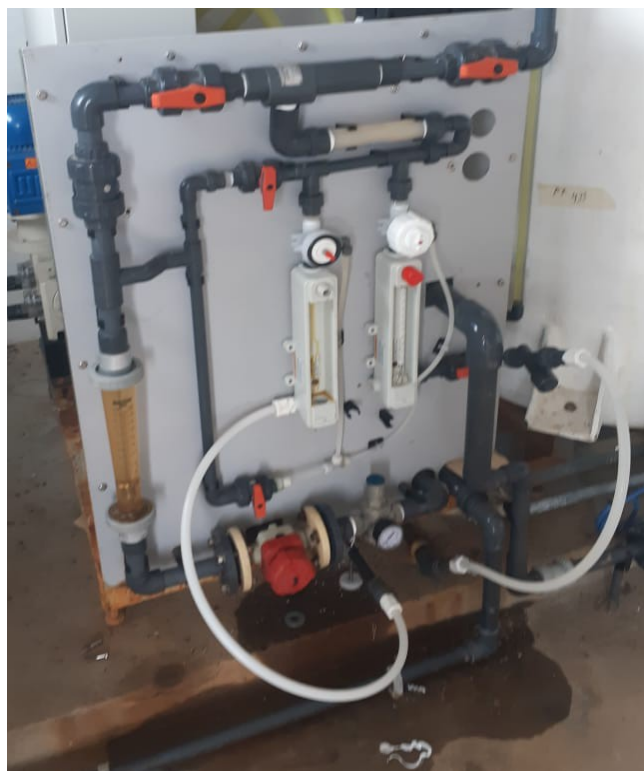
Figura N° 29: Generador de dióxido de cloro
