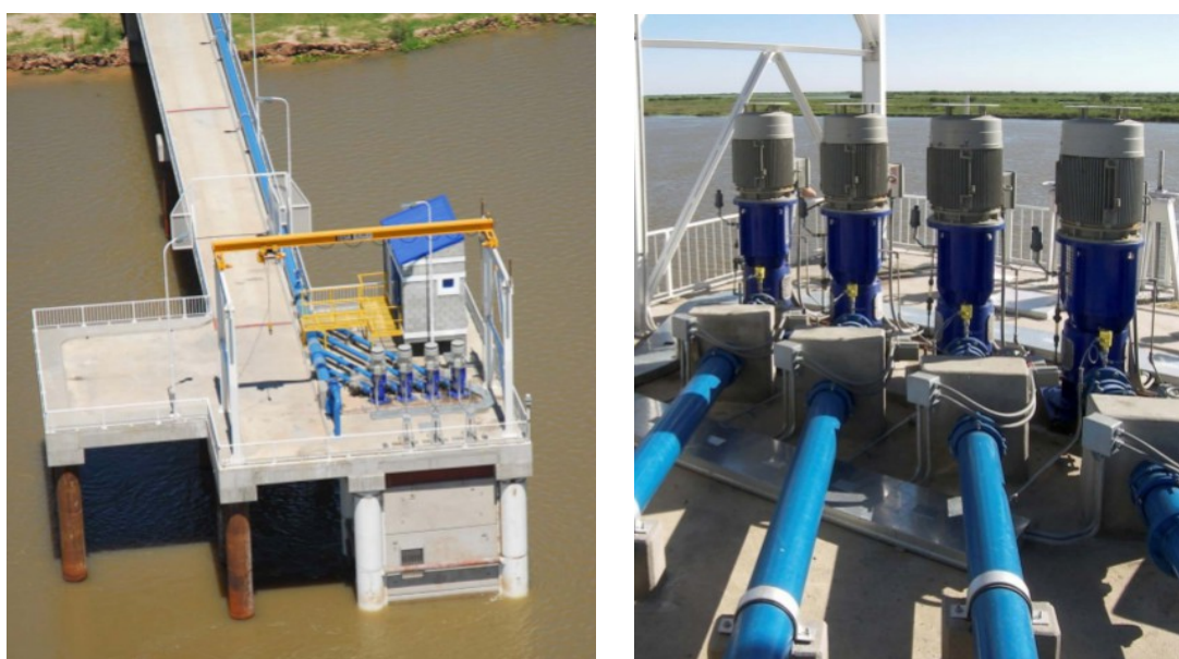
Figura N° 6: Obra de Toma y Bombas de la Planta Potabilizadora Monje - ACO
