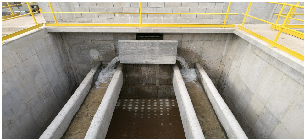
Figura N° 27: Filtro en etapa de llenado
