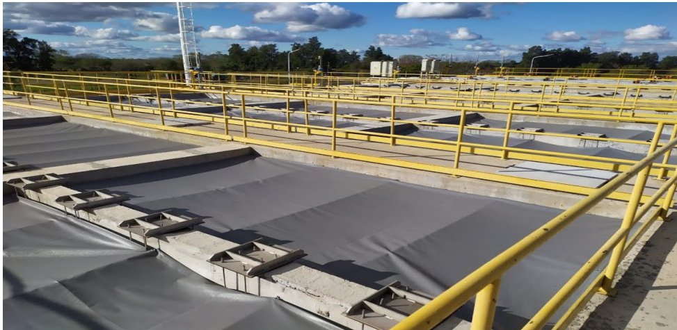
Figura N° 26: Sedimentadores con media sombra
