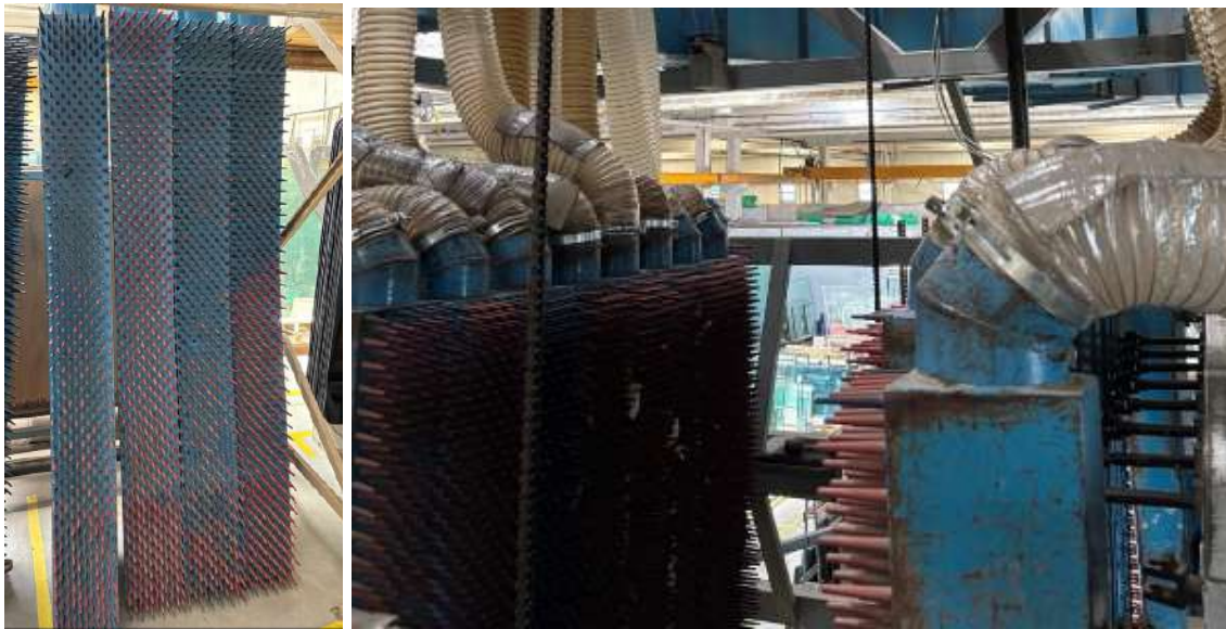
Figura 1-5: Módulos sopladores actuales.
