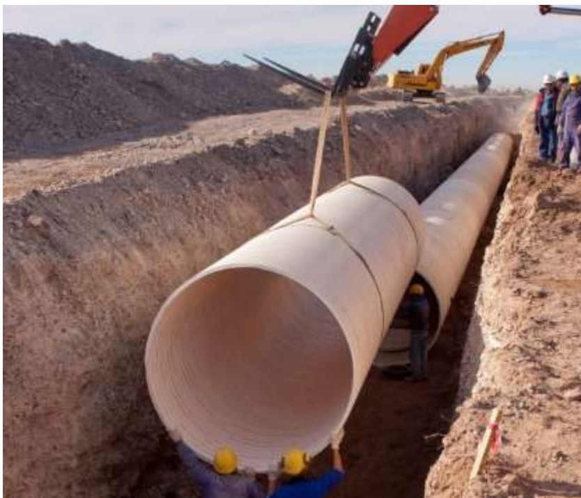
Ilustración 1: Acueducto San Javier-San Cristobal-Ceres-Tostado, Santa Fe, Argentina.
