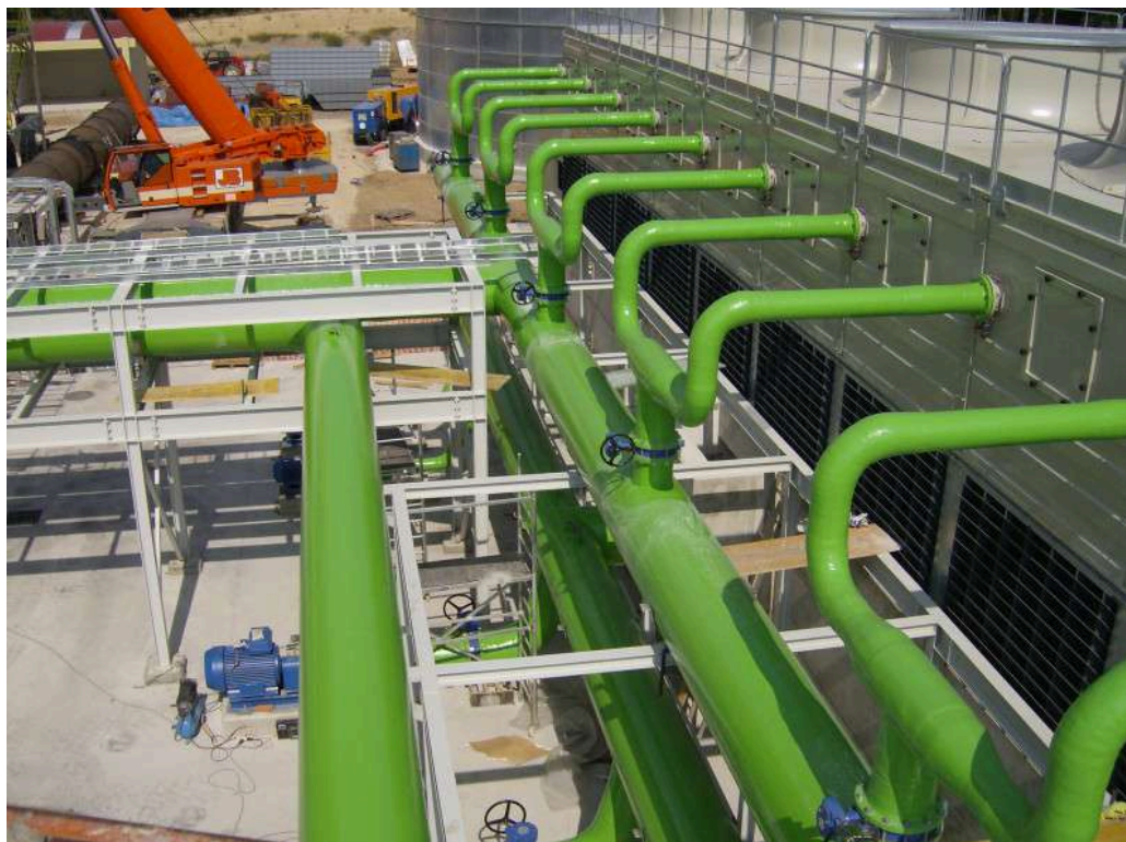
Ilustración 3: Sistema de tuberías de PRFV empleado en el circuito de refrigeración de una central de ciclo combinado. [18].
