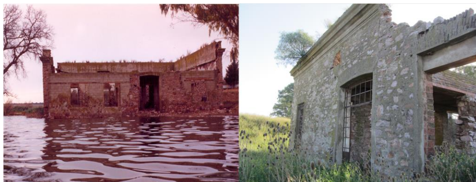
Figura 2. Restos de la casa de Rómulo Franco, a la izquierda en época de inundaciones, a la derecha como se observa en la actualidad. Se puede apreciar la construcción en piedra con detalles en ladrillo (aberturas) y los restos de una puerta metálica que originariamente debe haber llevado vitraux.
