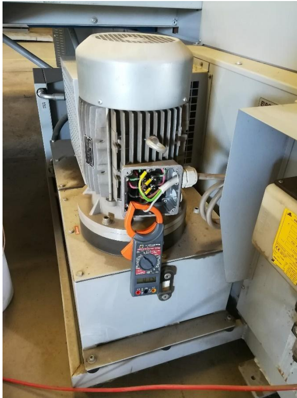
Figura 4.1.2.1: Medición de corriente.
