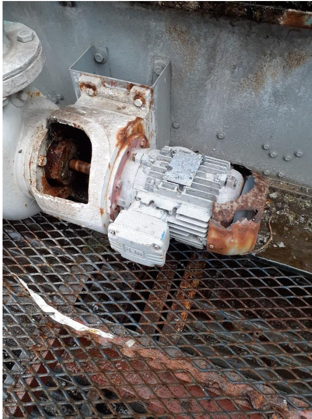
Figura 7.2.4: Motor 2HP Bombeo.
