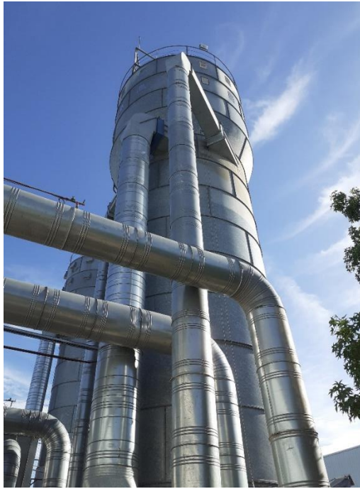
Figura 7.5.5: Silos de aserrín.
