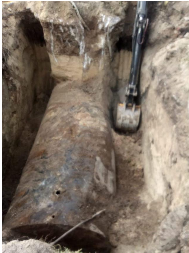
Figura 4.6. Tanque de almacenamiento de combustible enterrado
