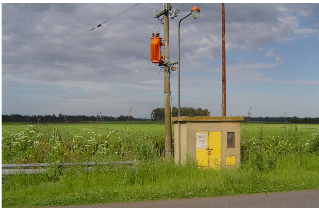
Figura 5.1. Pozo de abastecimiento sin perímetro de protección
