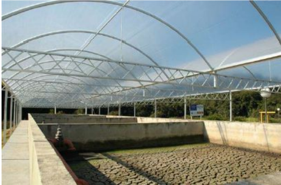
FIGURA 18: INTERIOR DE PLAYA DE SECADO CUBIERTA DE PLANTA DE TRATAMIENTO (FUENTE: FELCIO DOS REIS ET AL, 2011)
