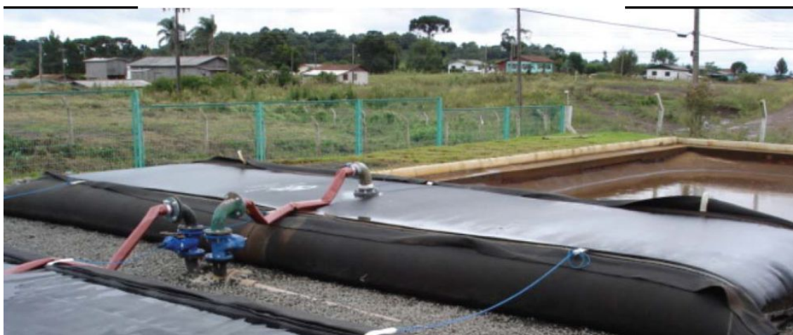
FIGURA 22: BAGS INSTALADOS EN LA PLANTA DE CURITIBANOS-SC (Q=90L/s)
