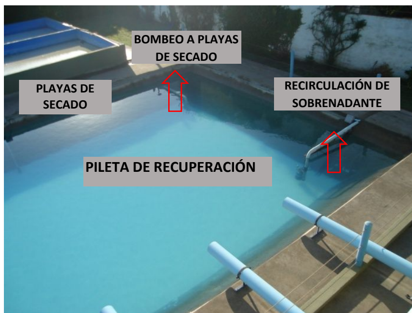
FIGURA 27: PILETA DE RECUPERACIÓN, PLANTA ARCIS-UNR®, LEZAMA PCIA. DE BS. AS.
