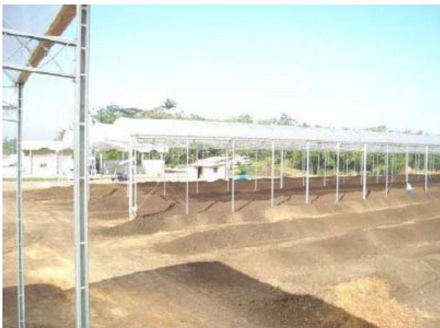
FIGURA 17: DISPOSICIÓN DE LODO EN PLANTA DE TRATAMIENTO DE DESAGÜES CLOCALES EN LÍNEAS DE COMPOSTAJE (FUENTE: FELCIO DOS REIS ET AL, 2011)
