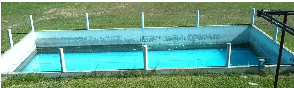
FIGURA 32: PILETA DE LAVADO
