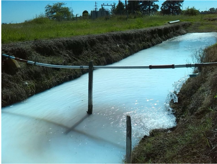
FIGURA 33: LAGUNA DE SECADO (EN OPERACIÓN AL MOMENTO DE LA VISITA)
