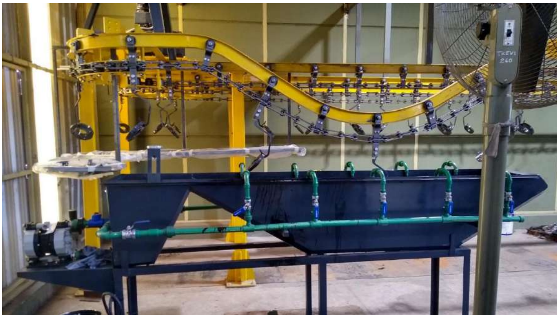
Figura 4-15: Cuba de pintura montada en línea
