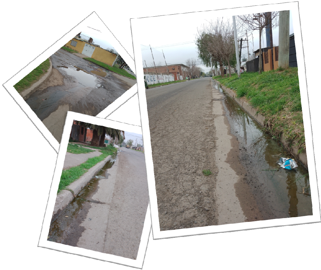
Figura n° 26: Cordón cuneta de zona Suroeste anegadas por las pérdidas en redes clandestinas.
