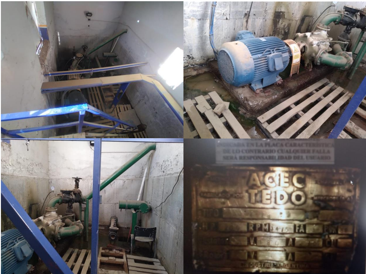
Estación de bombeo agua tratada.
