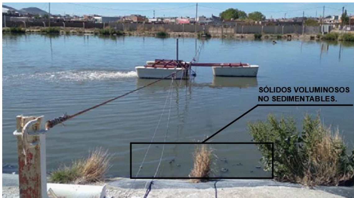
Imagen aireadores en laguna aireada
