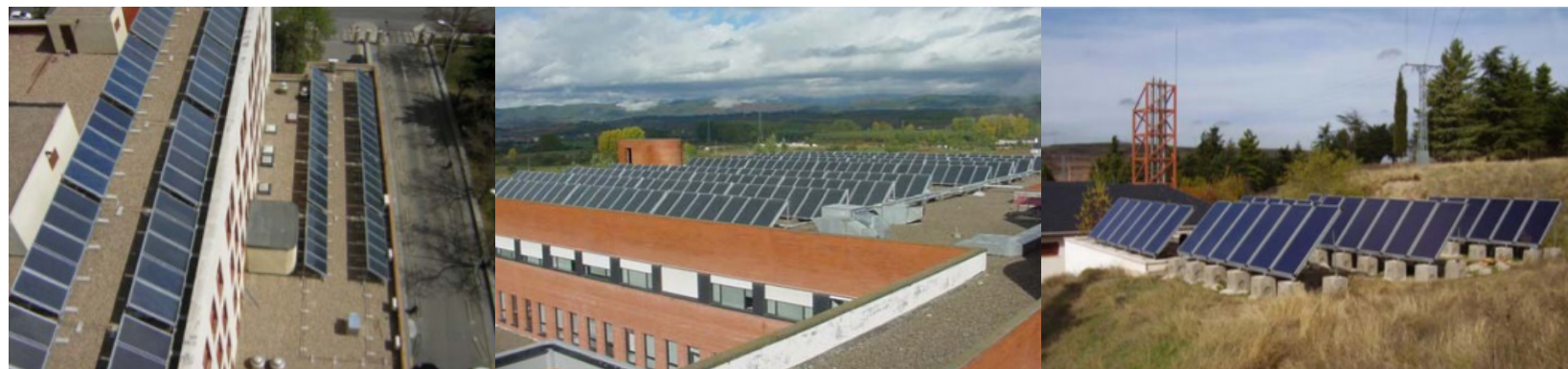
Instalaciones solares térmicas en hospitales, Programa HOSPISOL. Madrid, España (2001-2009)
