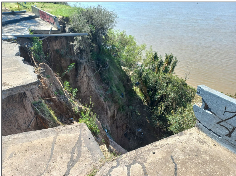
Imagen 1.4.4: Desmoronamiento de la barranca en la calle Juan B Justo.
