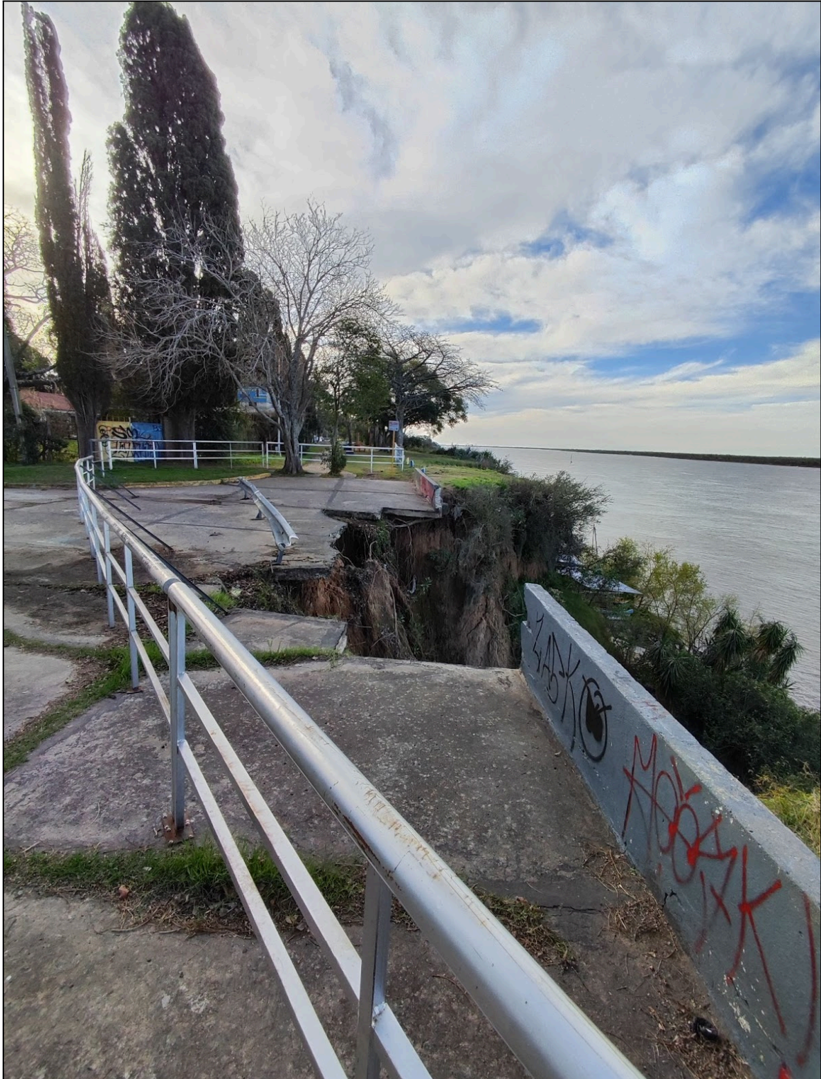
Imagen 1.4.3: Desmoronamiento de la barranca en la calle Juan B Justo.
