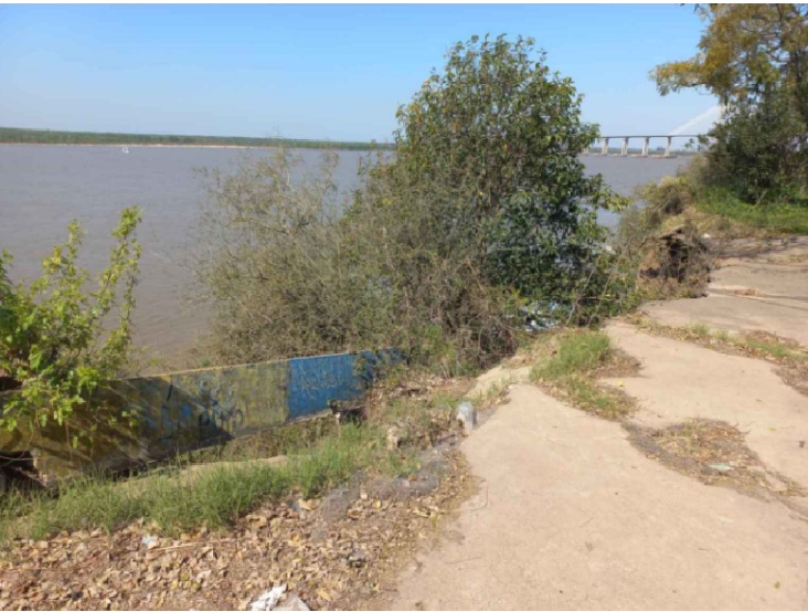
DESMORONAMIENTO CALLE SARMIENTO
