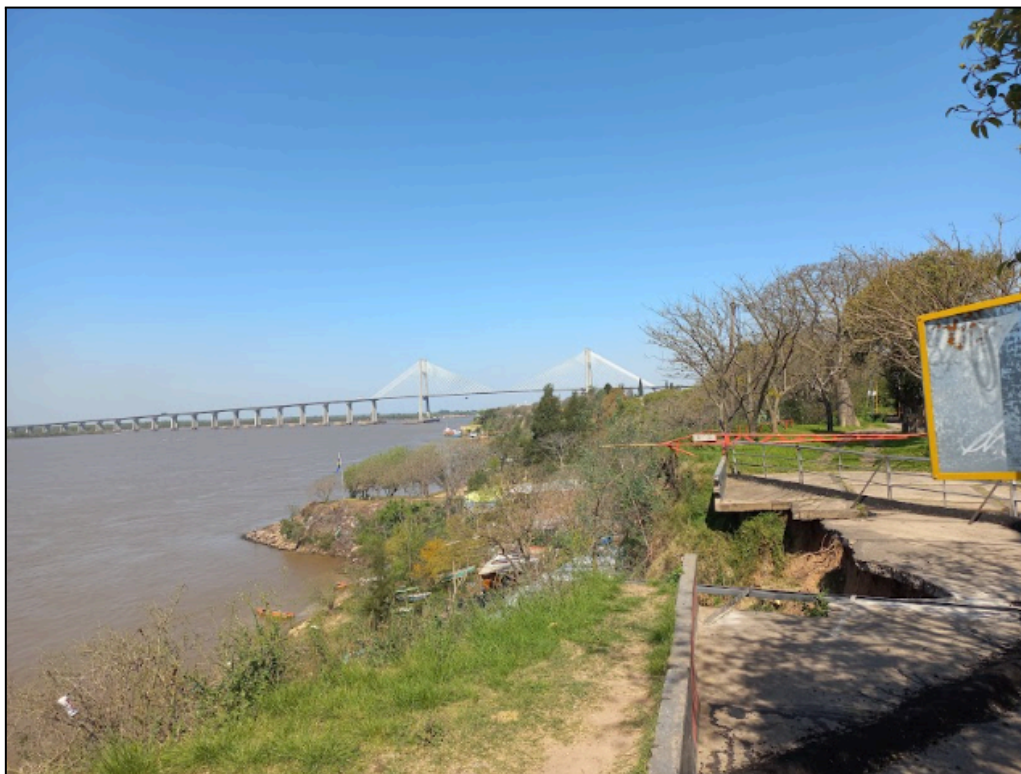
Imagen 1.4.6: Desmoronamiento de la barranca en la intersección con la calle Sarmiento.
