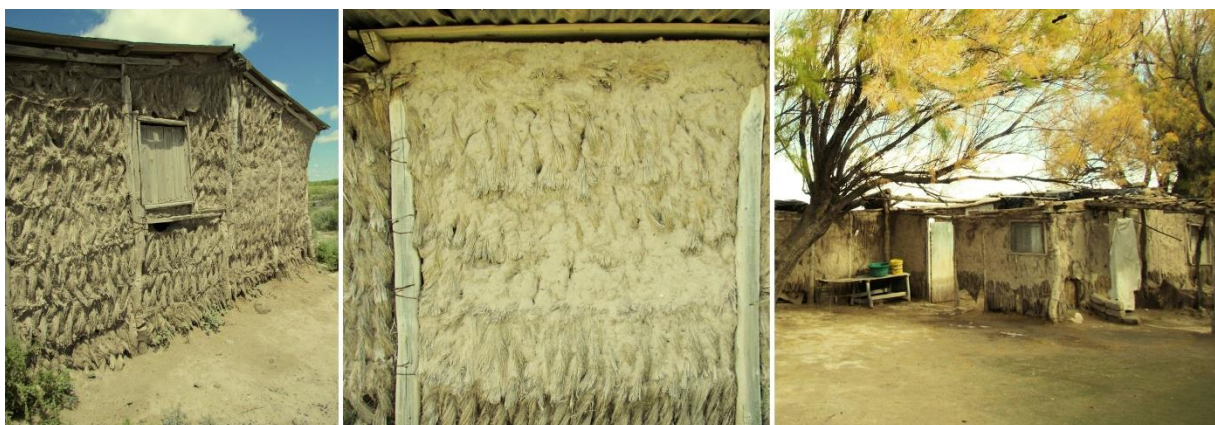
Figura 84. Envolvertes de chorizo en la zona a las que se le han lavado los revoques
