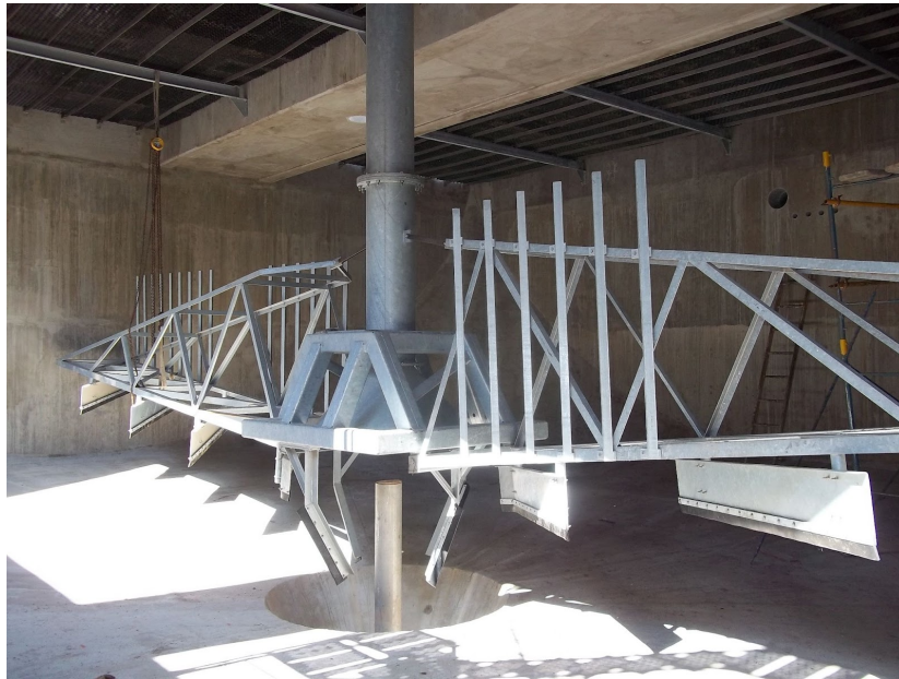
Figura Nº22 - Espesador por gravedad correspondiente a uno de los decantadores Hifloc ejecutados en la Etapa I de la Planta Potabilizadora de Granadero Baigorria.
