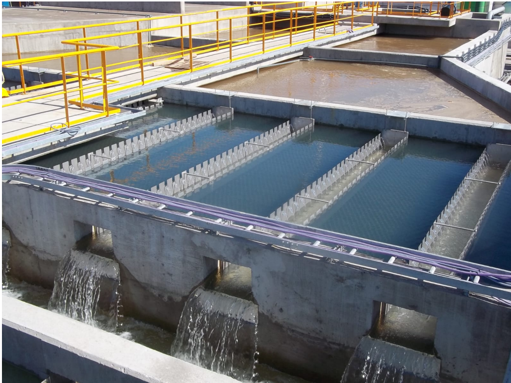
Figura Nº14 - Uno de los decantadores Hifloc del módulo de tratamiento correspondiente a la Etapa I, en funcionamiento.
