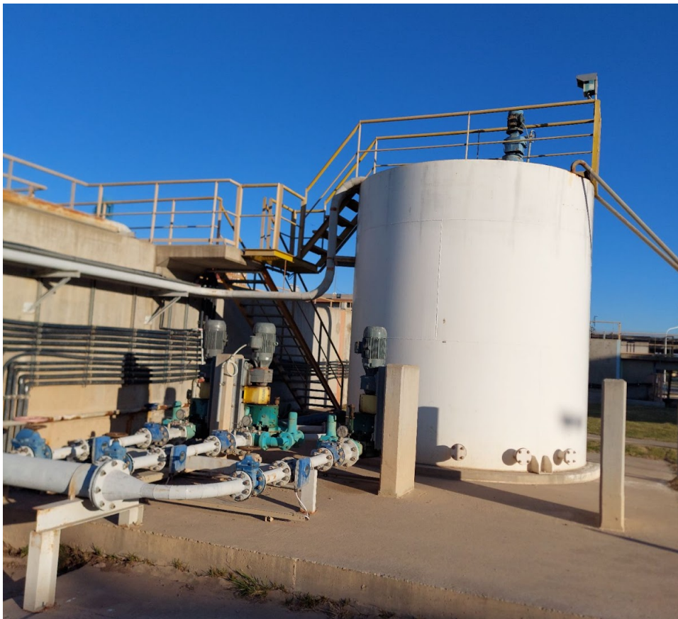
Figura N°33 - Tanque ecualizador existente destinado a la mezcla de lodos de cal y los generados en el proceso de decantación.
