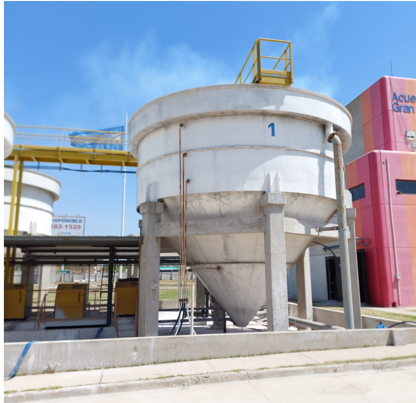
Figura Nº16 - Saturadores de cal.
