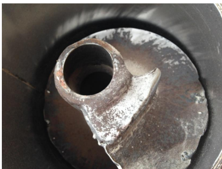
Figura 15: Tubo de descarga de la tolva. Alas del sin fin sinuoso y filoso.
