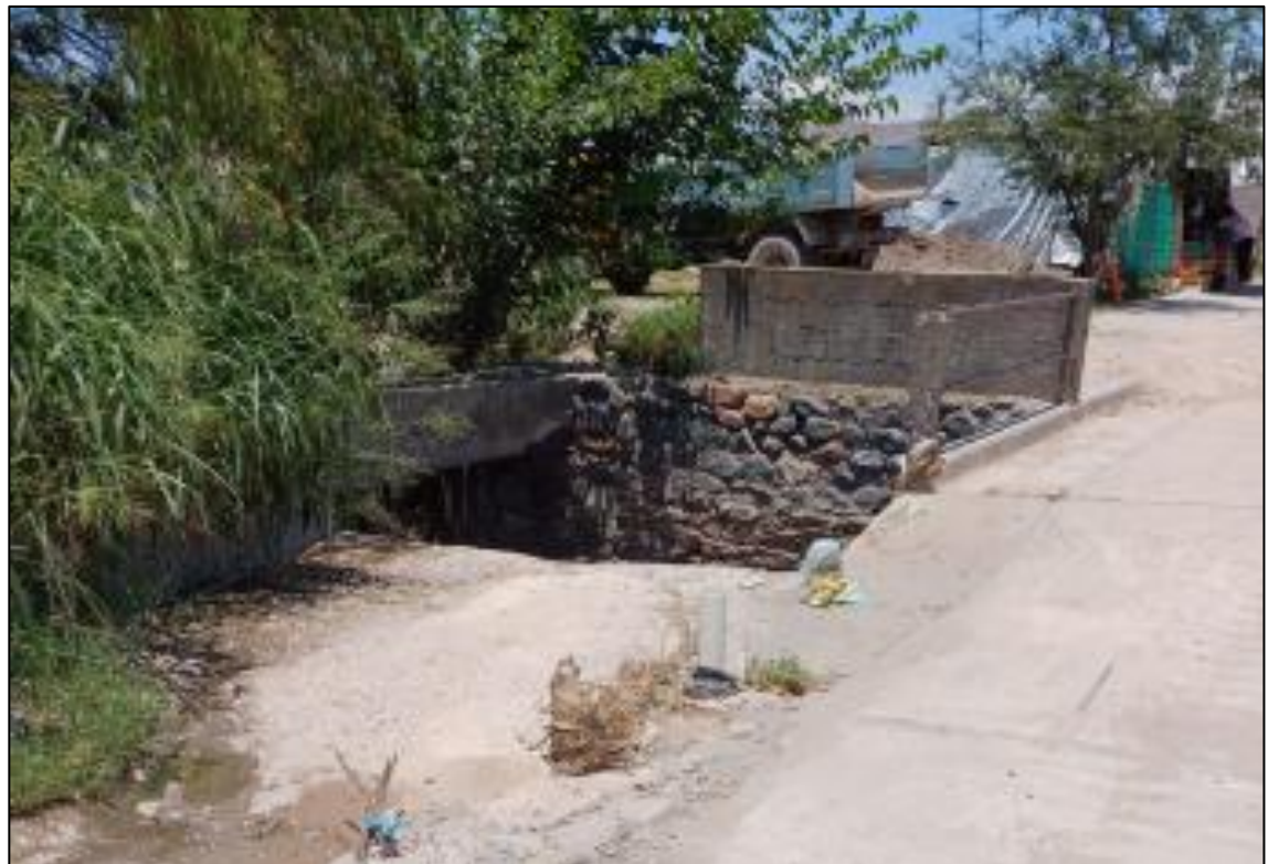
Figura 10. Desagües pluviales de la Localidad La Merced
