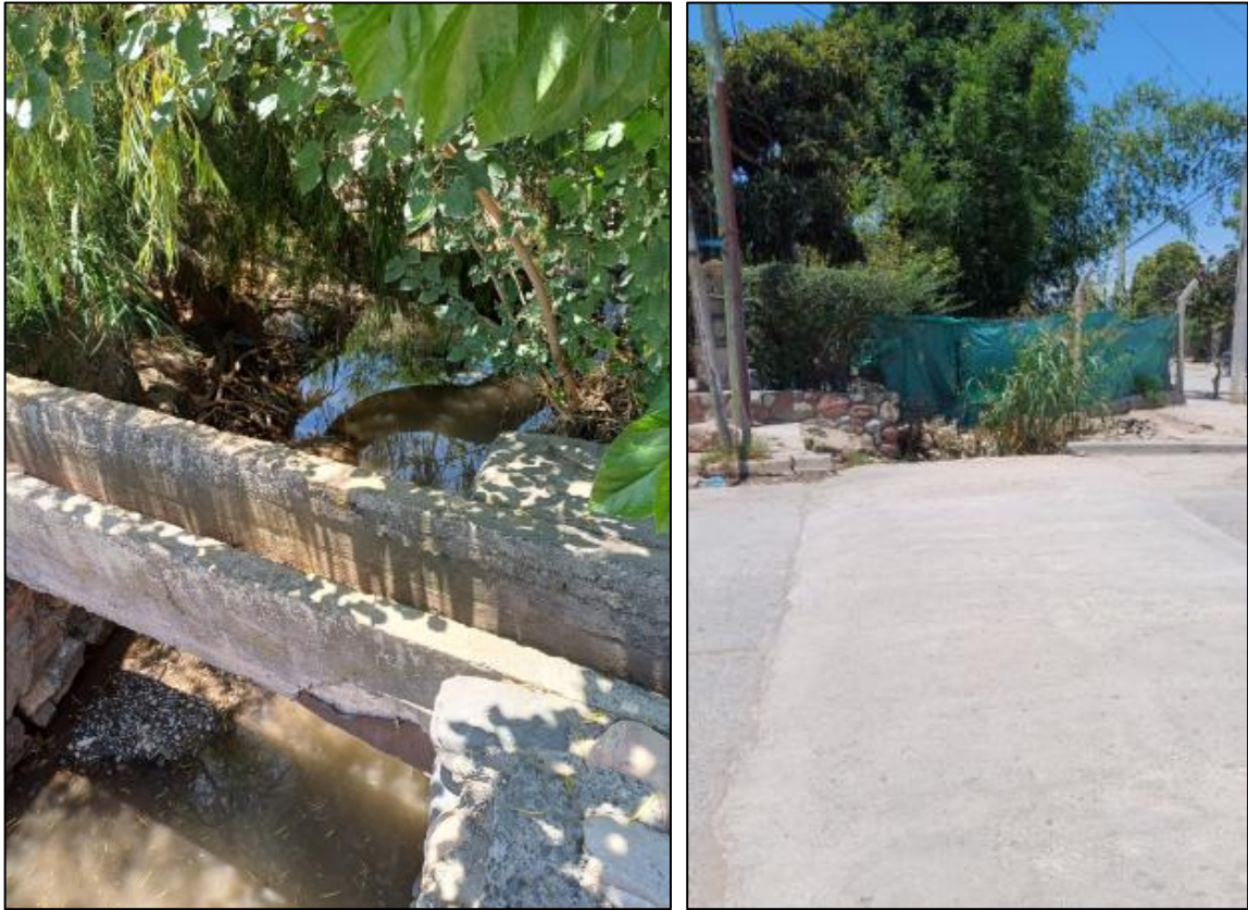
Figura 09. Canales existentes en calzadas en la Localidad La Merced
