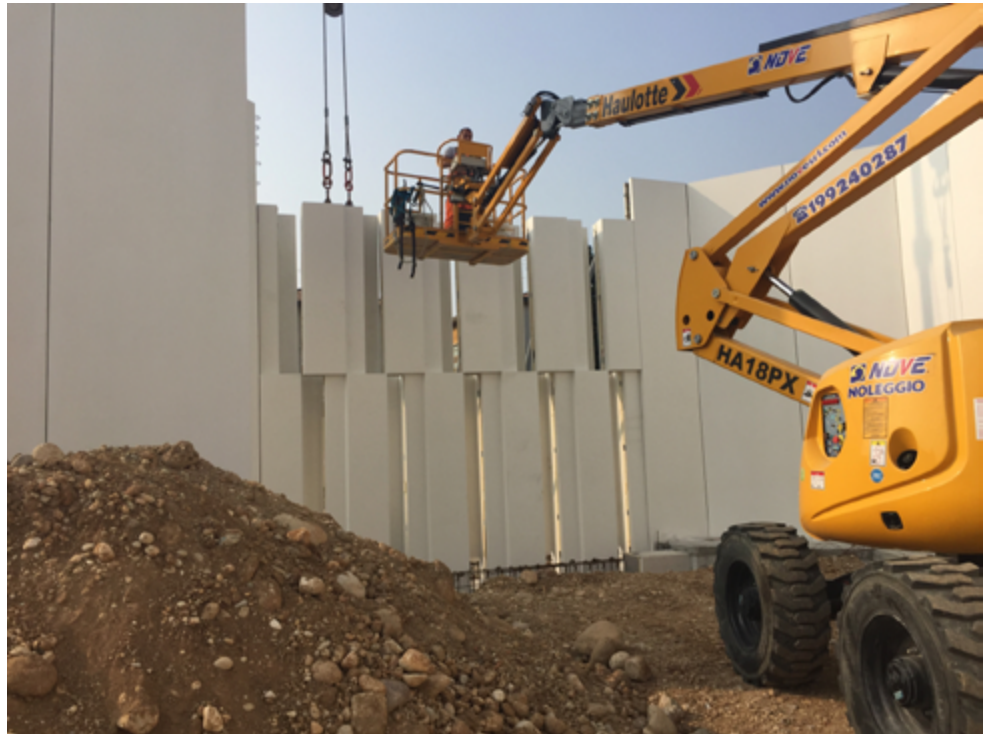
Construcción con elementos prefabricados de hormigón en cemento blanco, Centro parroquial e iglesia, Pescantina (2017) (Vr) Italia. Proyecto G.A.Carabajal con Nexus Associati. Foto: arq. R.Paoli.
