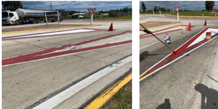
Figura 8- Ceda al Paso en la Rotonda de Ruta 3, imágenes extraídas por el Maestrando. Son Imágenes en el Pavimento que tienen 2 años de antigüedad y son ejecutadas sobre Pavimento de Hormigón. Se ejecutaron tareas de repintado sobre la Pintura Preformada inicial, repintándose en frío. Febrero del 2024.
