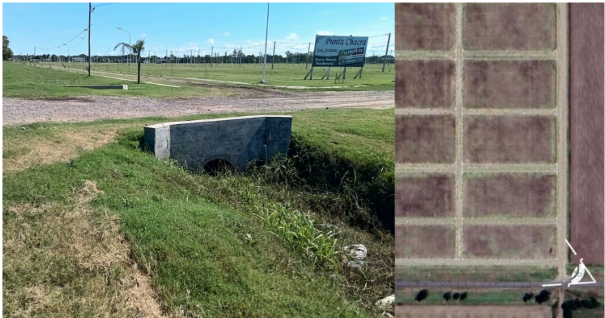
Imagen 3. Vista desde banquina de la RN N°9 hacia el noroeste. (Fuente: Elaboración propia).
