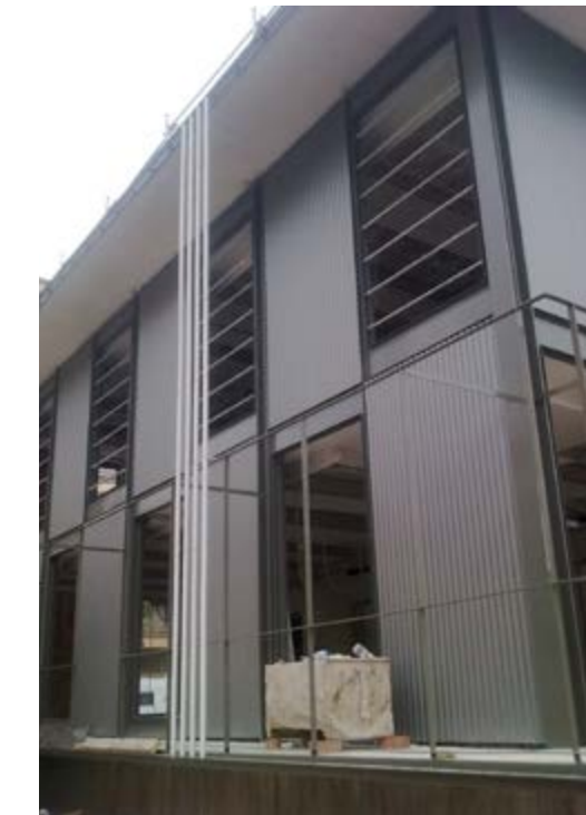
OAB, Biblioteca municipal en Vila Real, Castellón, Comunidad Valenciana, España (2009-2011). Montaje cortina cerámica de fachada. Foto Alberto Peñin
