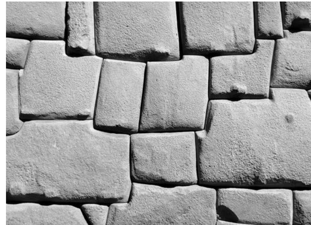
: "Juego abierto" en el aparejo irregular de un "muro inca" del Cuzco (Fotografía del autor, 2015).
