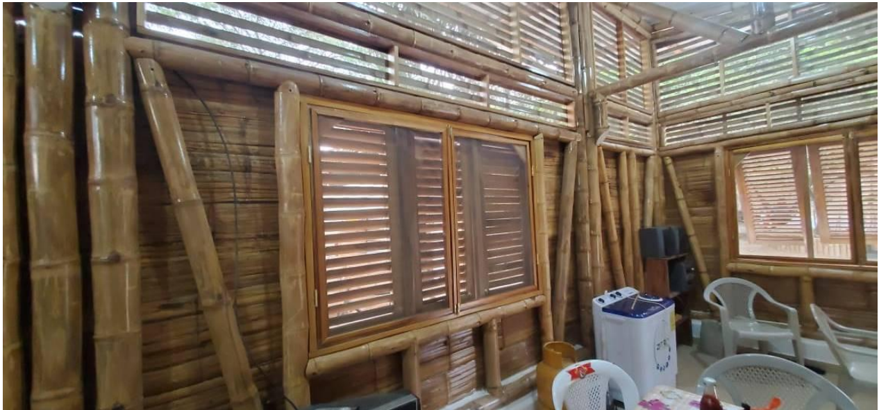
Figura 49. Casa de Bambú, Proyecto Ciudades ODS. Olmedo- Manabí. Vista interior de la envolvente estructurada en caña guadúa.
