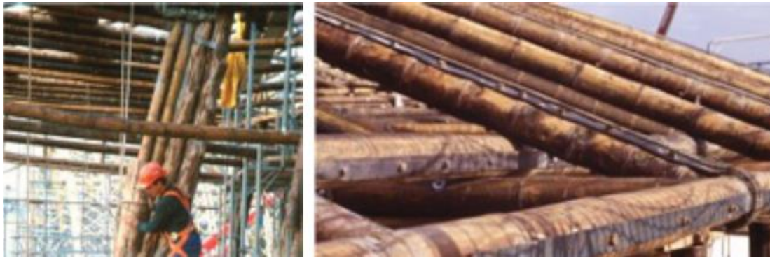
Figura 40. Instalación de columnas y anillos de soporte de guadúa – refuerzo del techo.
