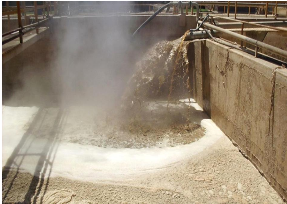
Figura 11. "Bajada de producto en pileta de almacenamiento".
