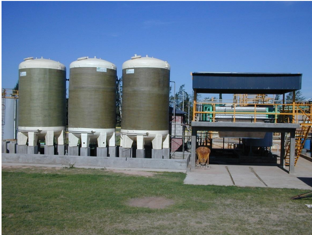
Figura 16. planta de tratamiento de residuo insoluble
