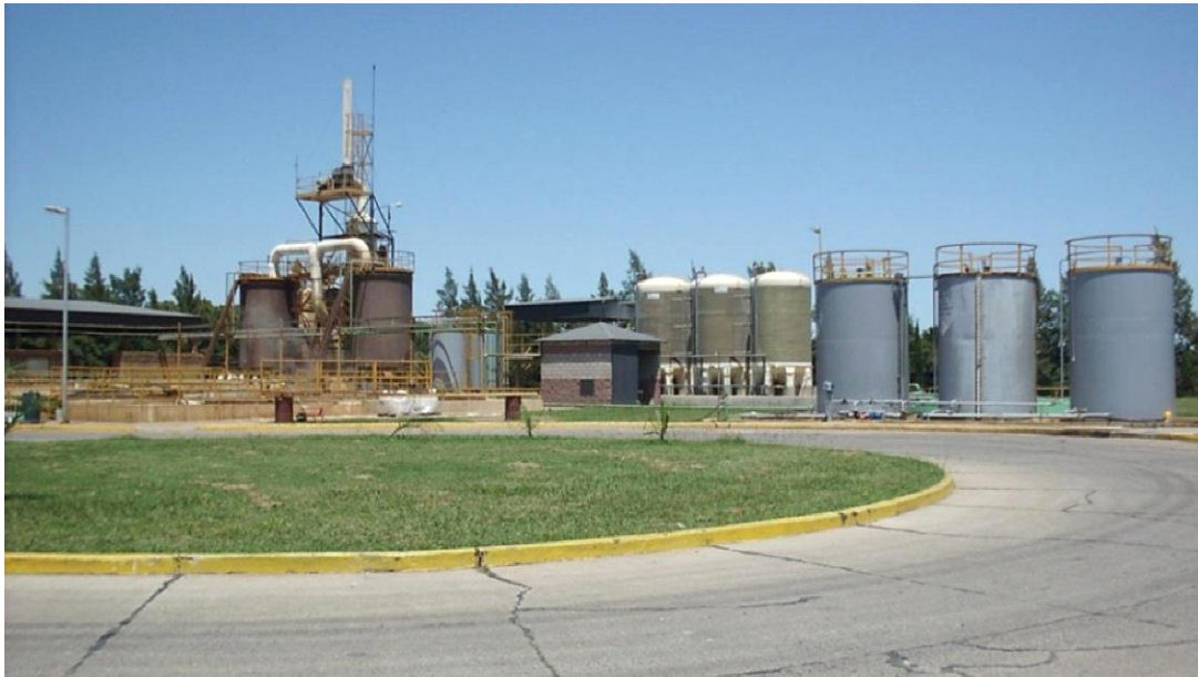
Figura 7. "Tanques de Almacenamiento de Ácido Sulfúrico".
