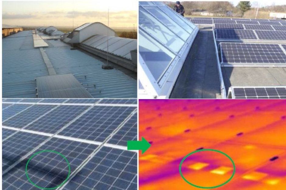
Figura 131 Módulos fotovoltaicos con sombras como consecuencia de lucernarios, pararrayos y líneas eléctricas (PI Berlín AG)
