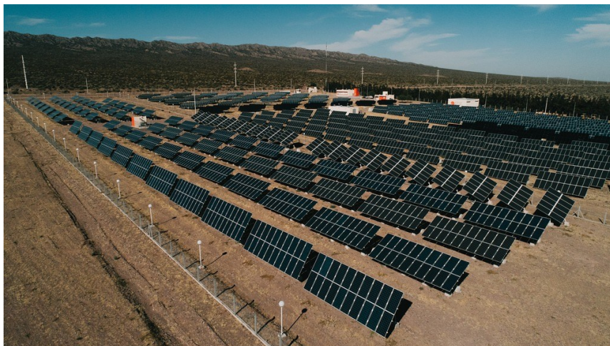
Figura 66 Planta fotovoltaica sobre suelo. Ullum, San Juan, Argentina ( https://www.regionbinacional.com/san-juan-avanza-en-generacion-investigacion-energias-alternativas/ )
