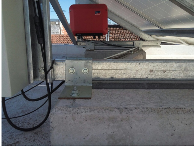
Figura 117 Cableado alojado en los perfiles de la estructura metálica y sujetado con precintos resistentes a los rayos UV (fotografía de autoría propia)
