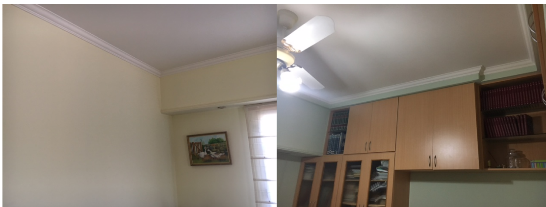
Figura 107 Relevamiento fotográfico del estado interno de la construcción de una vivienda seleccionada, en la ciudad de Armstrong, Santa Fe (fotografías de autoría propia)
