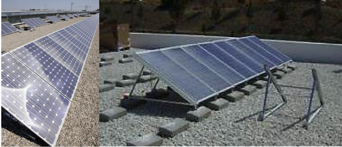
Figura 72 Instalación fotovoltaica sobre estructura portante apoyada con bases de hormigón sobre cubierta plana con grava. Centre Esplai. Barcelona, España ( https://www.buenosaires.gob.ar/sites/gcaba/files/documents/sistemas_fotovoltaicos_aplicados_a_la_arquitectura.pdf )
