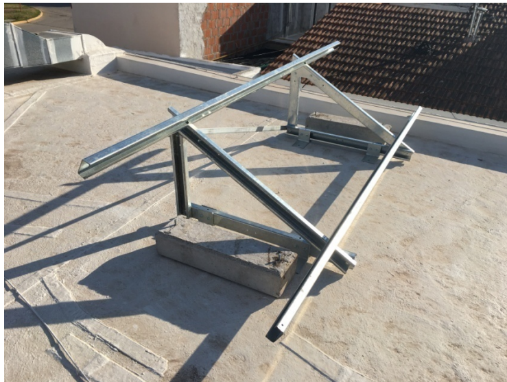
Figura 112 Estructura metálica de una mesa de paneles FV (fotografía de autoría propia)
