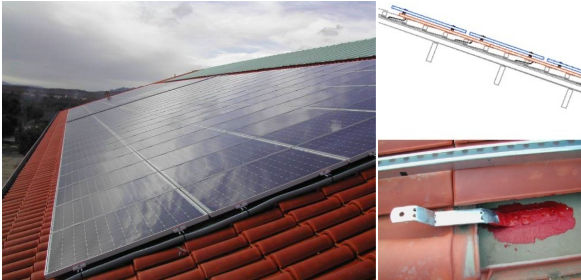
Figura 70 Instalación fotovoltaica sobre techo inclinado con tejas y detalle de sujeción de la estructura portante. Polideportivo Miraflores de la Sierra. Madrid, España ( https://www.buenosaires.gob.ar/sites/gcaba/files/documents/sistemas_fotovoltaicos_aplicados_a_la_arquitectura.pdf )
