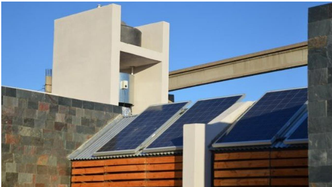
Figura 9 Integración de paneles fotovoltaicos a la cubierta de la vivienda (CEDU)
