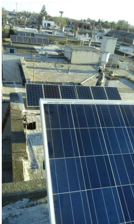
Figura 119 Instalaciones fotovoltaicas en 3 cubiertas de viviendas (fotografía de autoría propia)
