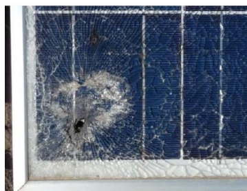
Figura 125 Rotura de módulo FV por impacto mecánico (Berlin AG)
