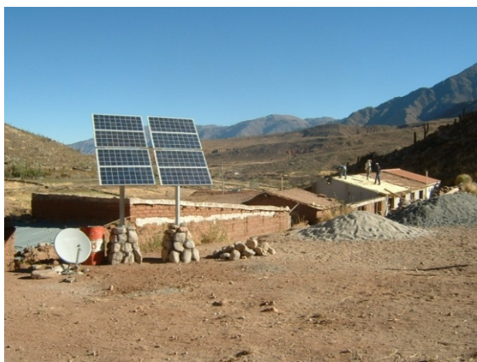
Figura 22 Instalación fotovoltaica del PERMER, en colegio estatal rural "Madre Teresa de Calcuta". Alumbre, Salta ( https://www.energiaestrategica.com/empresa-adjudicataria-de-8-500-instalaciones-fotovoltaicas-del-permer-pide-prorrogas-en-los-plazos-de-ejecucion-los-argumentos/ )
