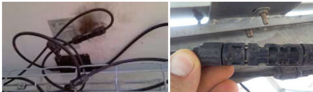
Figura 128 Conectores quemados por mala conexión (izq.) (DGS Berlin e.V.). Conector no debidamente cerrado (der.) (PI Berlin AG)
