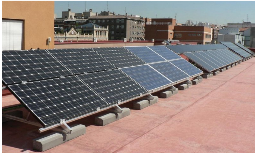
Figura 67 Instalación fotovoltaica sobre cubierta plana de la Escuela Técnica Superior de Ingeniería y Diseño Industrial, Universidad Politécnica de Madrid ( https://firestation.wordpress.com/2014/05/25/prevencion-y-actuacion-frente-a-incendios-de-edificios-con-instalaciones-fotovoltaicas/ )
