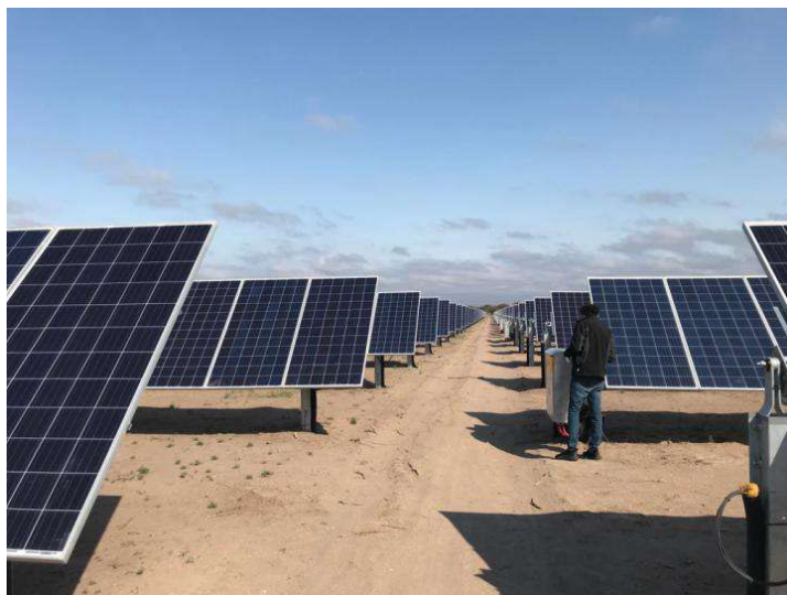
Figura 26 Planta fotovoltaica de 22 MW de la Ronda 1,5 del Programa RenovAr. La Cumbre, San Luis ( https://energialimpiaparatodos.com/2018/09/14/argentina-san-luis-con-2-nuevas-plantas-de-energia-solar/ )
