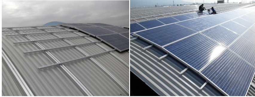
Figura 74 Sistema de soportes para colocación de paneles fotovoltaicos convencionales sobre cubierta curva ( https://www.archiexpo.com/prod/alubel/product-1652-222623.html )
