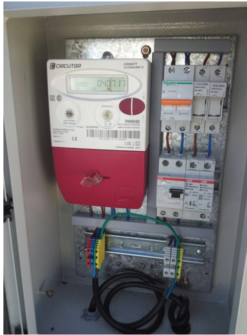
Figura 113 Armado de gabinete de protecciones y medidor (fotografía de autoría propia)
