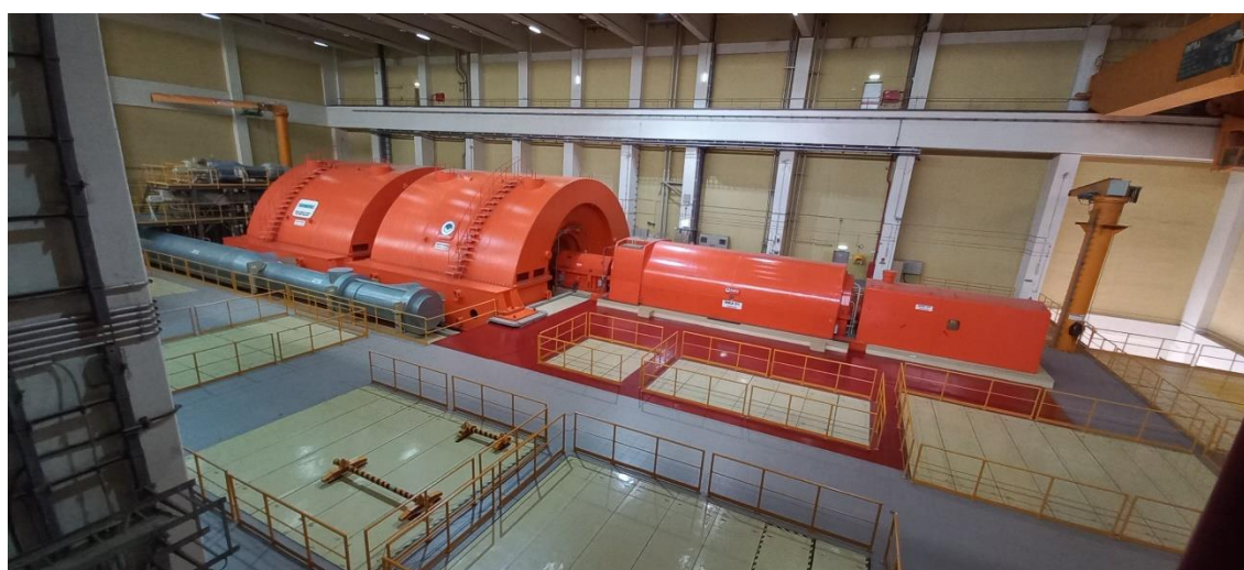
Figura 7-20: Sistema de turbina y alternador en Central Atucha II
