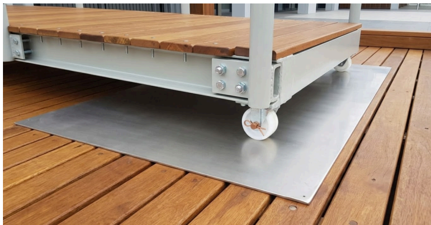
Imagen 31b. Apoyo móvil de la pasarela de aluminio. Fuente: Autoría propia.
