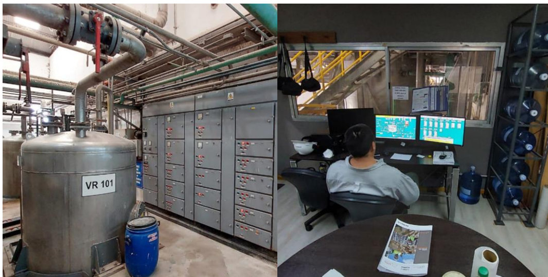
Figura 10. Izquierda: sector de enfriamiento. Derecha: panel de control general.
