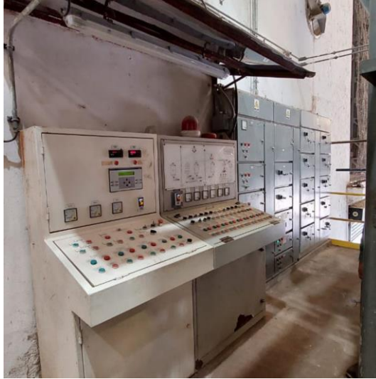
Figura 7. Panel de control de válvulas mariposas
