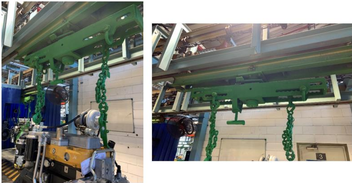
Imagen 33: Fotografías ilustrativas del tren de cadenas y sistema de traslado del motor
