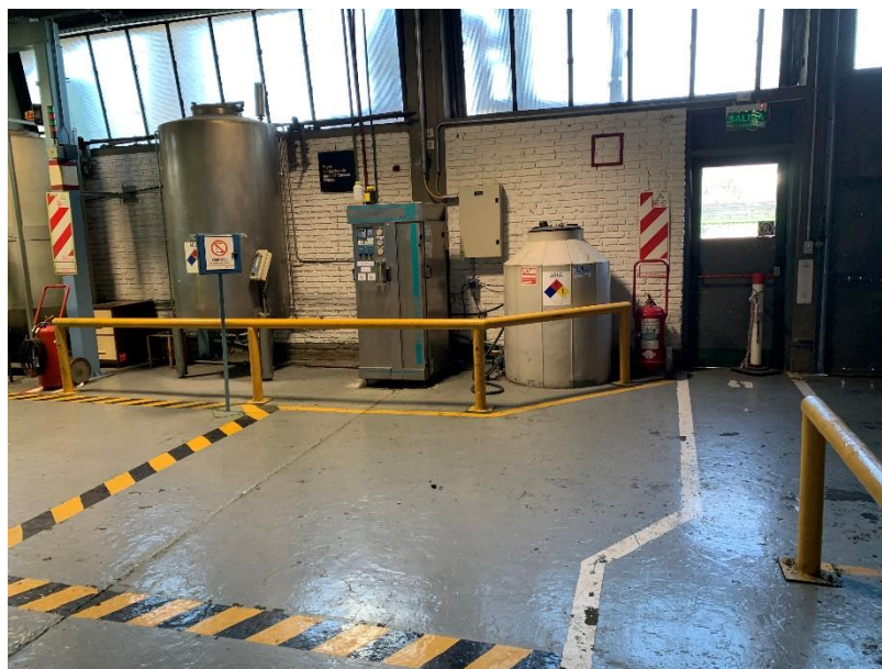
Imagen 32: Fotografía ilustrativa indicando ubicaciones de matafuegos y salidas de emergencia del sector
