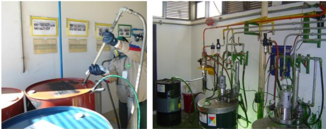
Imagen 133: Fotografías ilustrativas del interior del Cuarto de Dosificación
