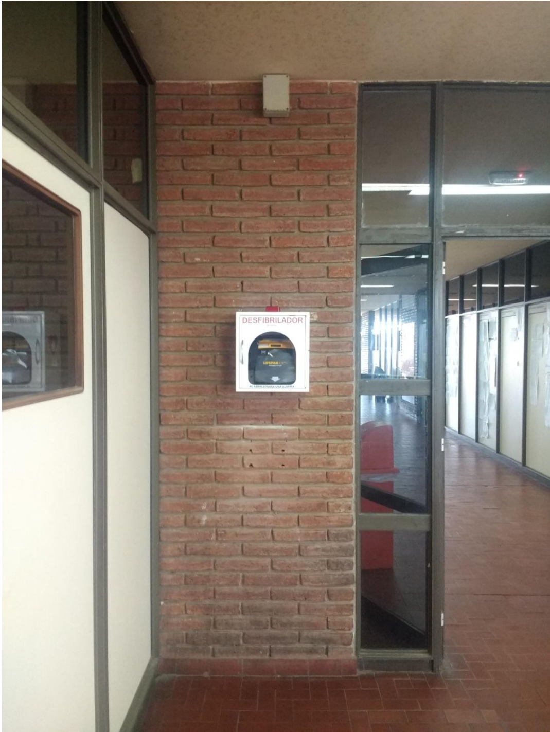
Figura 19. Fotografía del DEA, dispuesto junto a la puerta de Bedelía, en el primer piso del edificio de la FAPyD. Fuente: elaboración propia.
