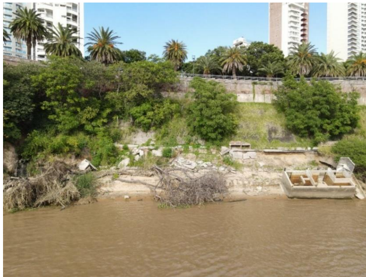
Ilustración 1.3-5. Situación actual zona deslizada vista desde el río Paraná.
