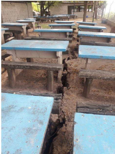
Ilustración 1.3-2. Importante grieta en zona de baños del club.
