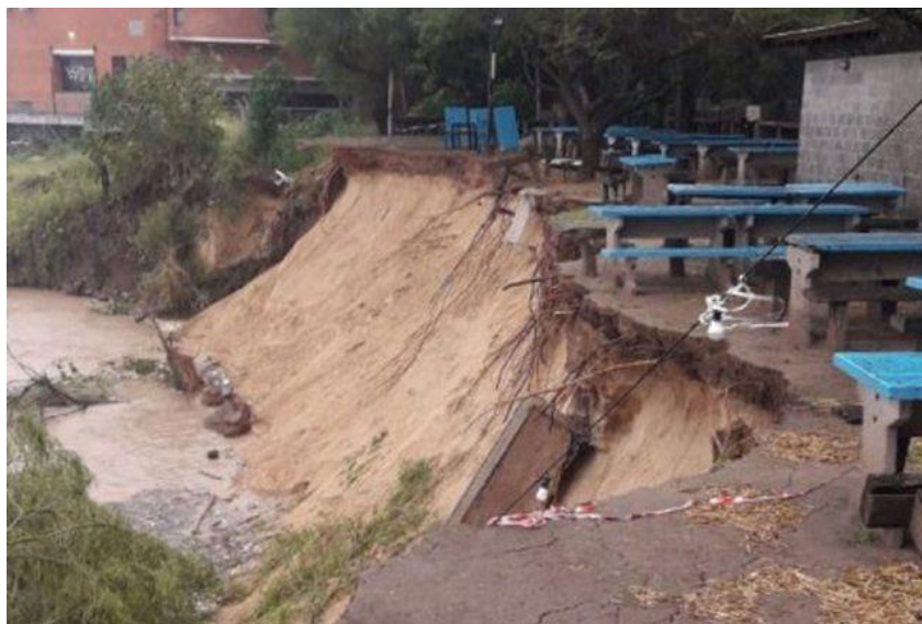
Ilustración 1.3-3. Situación posterior al deslizamiento.
