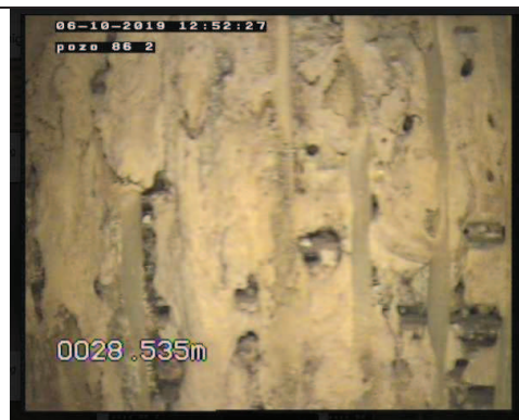
Imagen 5.13. Vista del primer tramo de filtro sumergido. Se observan zonas obstruidas con incrustaciones en el pozo A.
