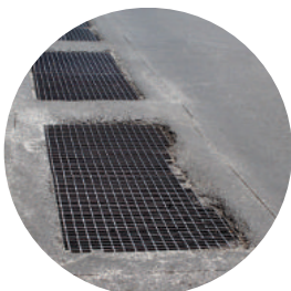
REJILLAS METÁLICAS PARA DRENAJE DEL AGUA DE LLUVIA
