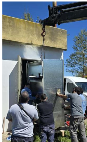
Figura 7: Proceso de ingreso de celda.
