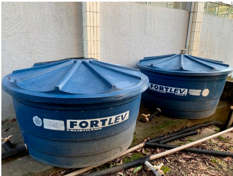
Figura 2.12: Caixas D'água usadas na captação da água da chuva.
