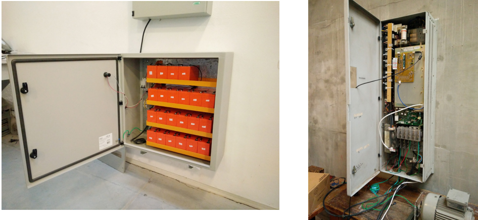
Figura 6. Banco de baterías (izq.) y CEP del emulador de TE de 30 HP (der.).
