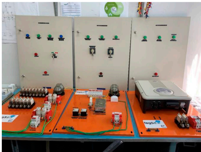
Figura 2.3 - Quadros de proteção e comando.
