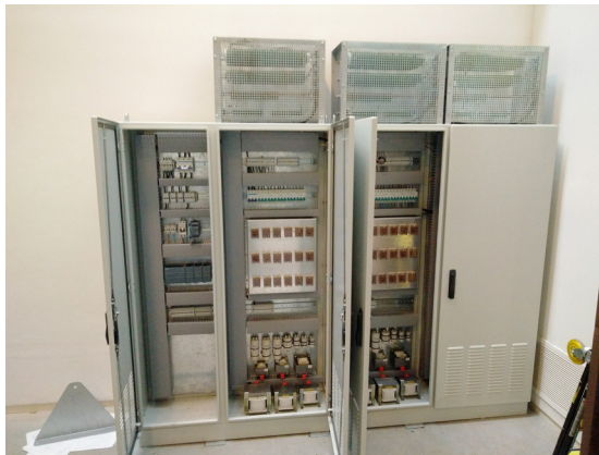
Figura 8. Armario de cargas: PLC y módulos de control (izq.); 2 fases (centro) con relés estado sólido y cargas capacitivas e inductivas; resistencias (arriba).
