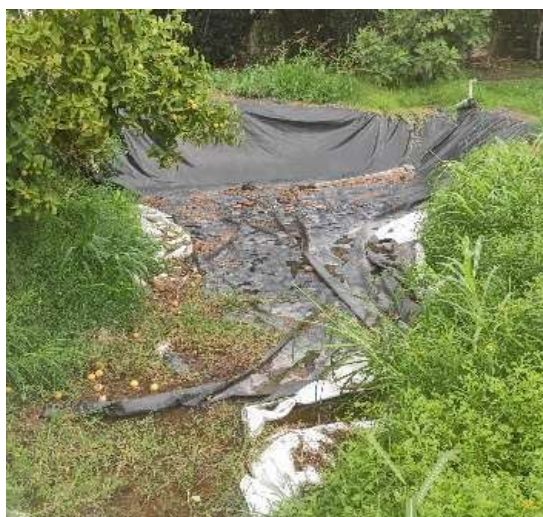
Figura 11. Reservorio de agua mal ejecutado.
