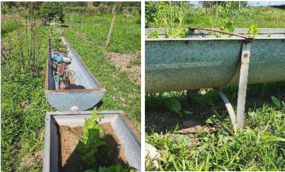
Figuras 38 a y 38 b Canaletas de acero galvanizado en desuso
