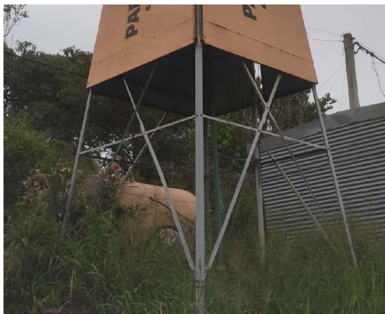
Figura 3. b Tanque de 10000 l inutilizado ubicado en su base.
