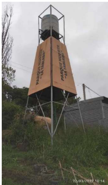
Figura 3. a Tanque de reserva.
