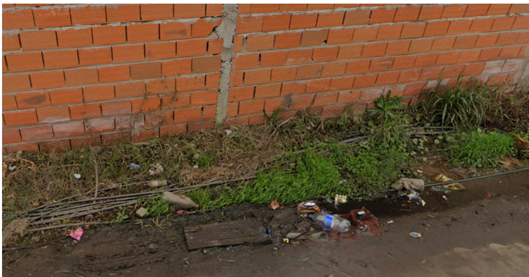
Figura 20. Conexiones irregulares en barrio Piamonte, Rosario (2023). Fuente: GoogleMaps.
